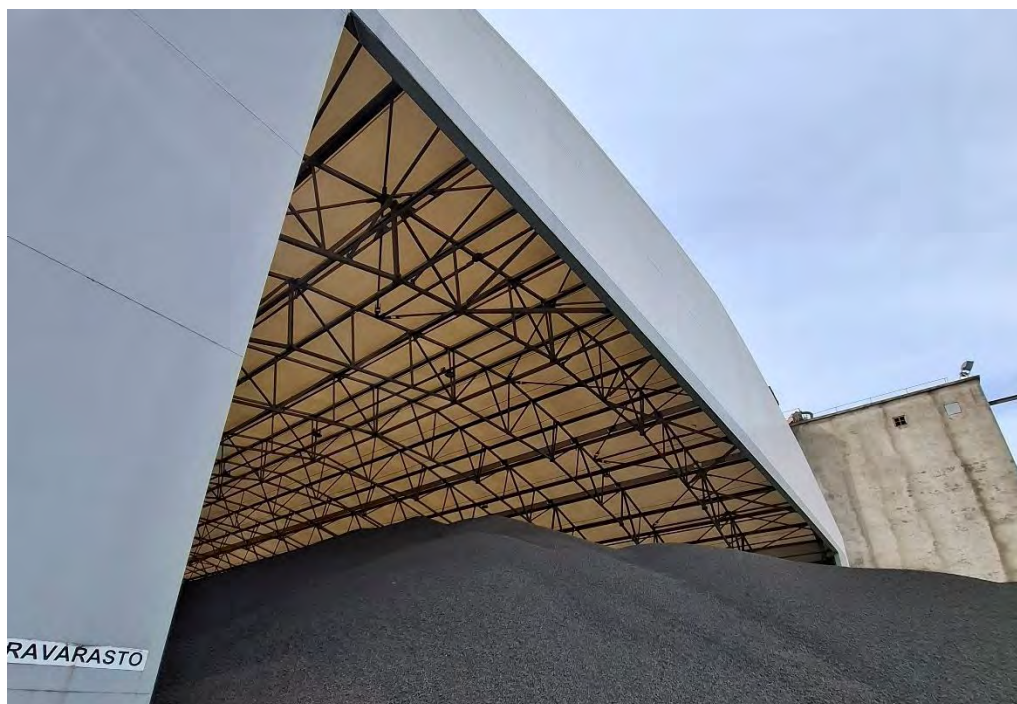
Kuva 4. Varastohalli, jonka rakenteissa nähtiin räystäspääskyjen pesiä.
