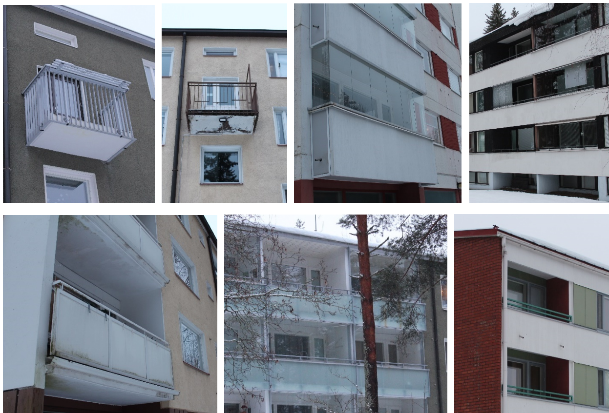
Kuvat 45-52. Parvekkeissa on paljon eroa eri rakennusten välillä.
