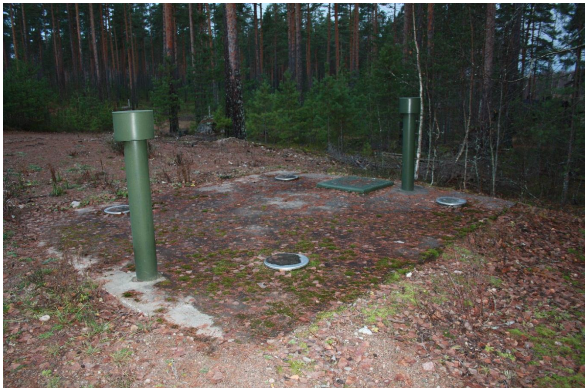
Kuva 6.5.Haukkajärven vedenottamon neljän kaivon ryhmä.
