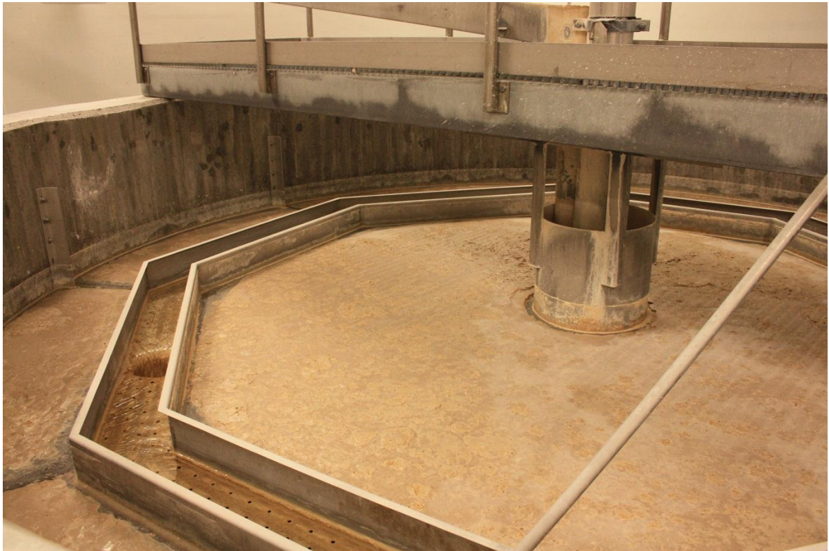
Kuva 6.6. Raakaveden käsittelyallas Kuivalan tekopohjavesilaitoksella. Noin puolet imeytettävästä vedestä esikäsitellään ennen imeytystä. Esikäsitelyssä vedestä poistetaan humusta.
