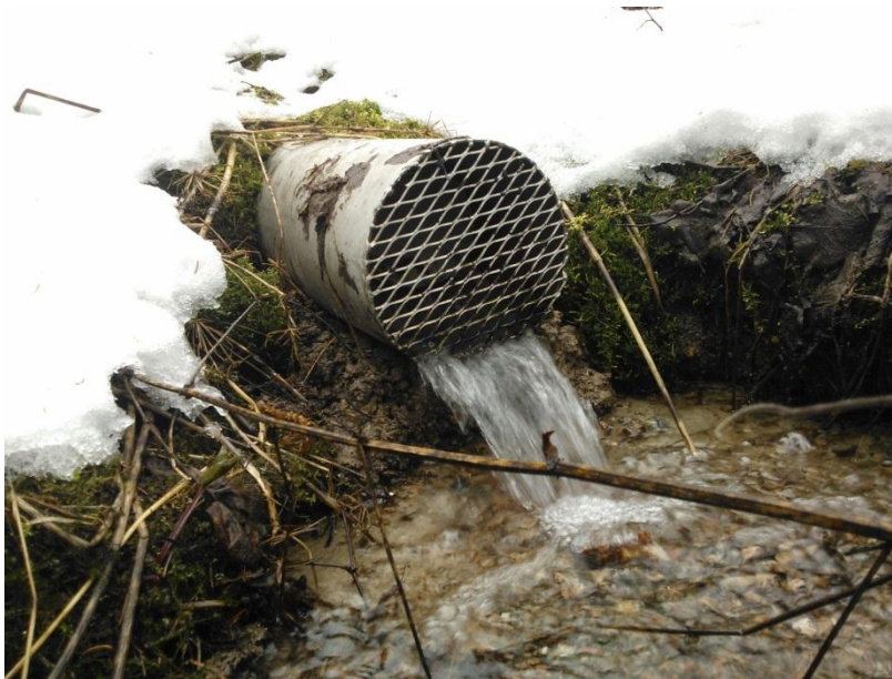
Kuva 5.5.2 Tuohikotin vedenottamo on perustettu lähdepaikkaan. Kaivosta on jatkuva pohjaveden ylivuoto.
