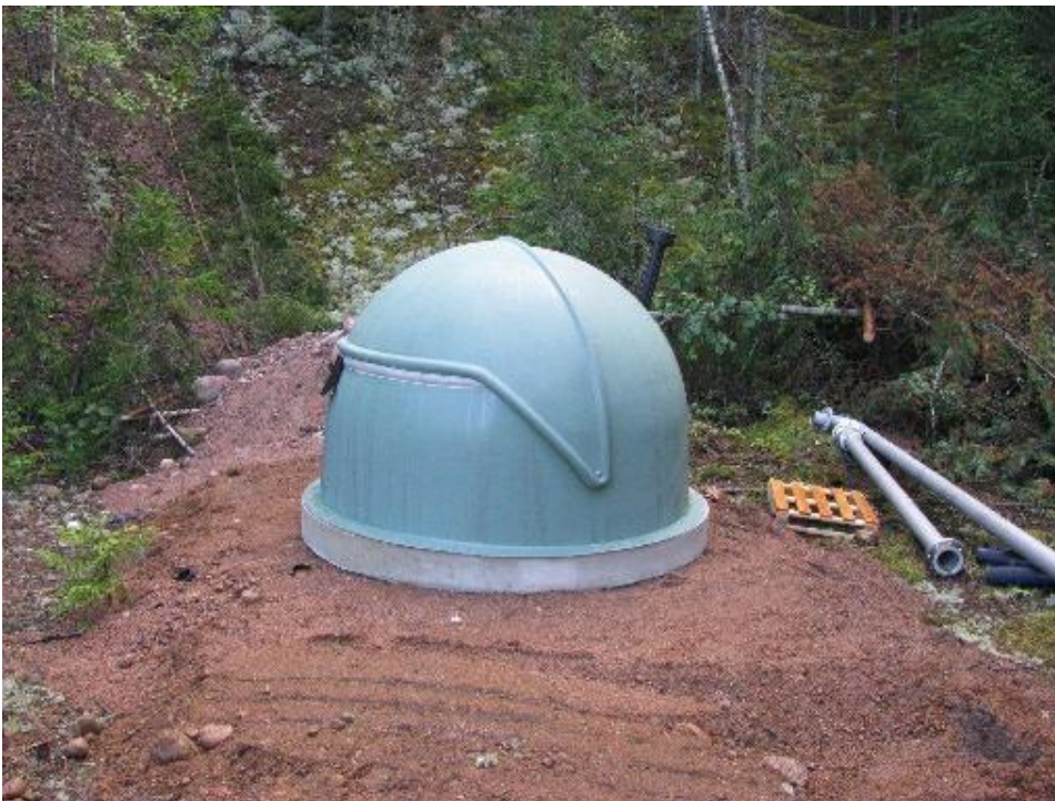
Kuva 2. Vuohijärven saneerattu vedenottamo (kuva: Esa Houni).
