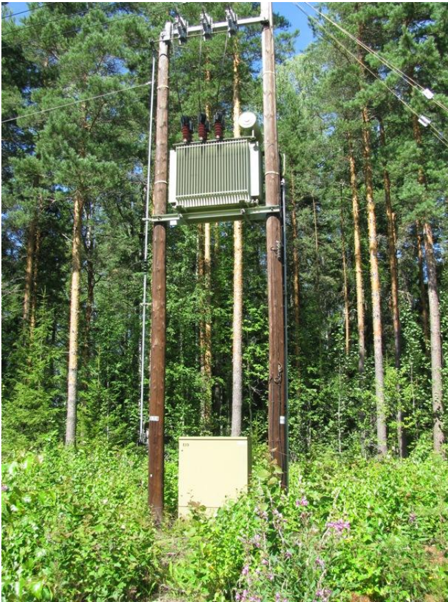
Kuva 6. Pylväsmuuntamo Okanniemen pohjavesialueella vedenottamon välittömässä läheisyydessä.
