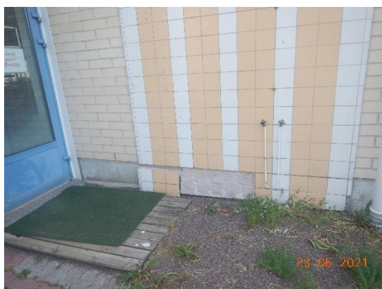
Kuva 8 Rantasaunalta tuovan sisäänkäynnin edusta on heinittynyt.
