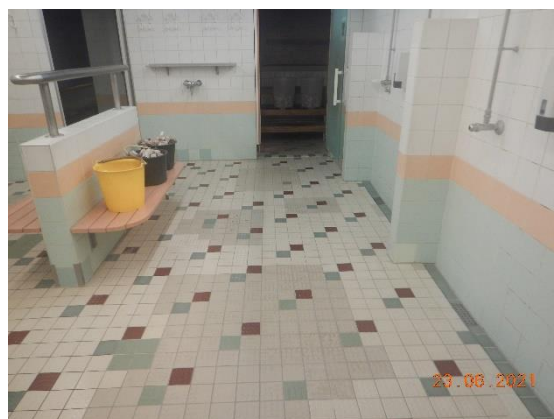
Kuva 37 Pesutilojen lattiapinnoilla havaittiin kohonneita pintakosteuslukemia kautaltaan, mikä on normaalia laatoitetuissa märkätiloissa.
