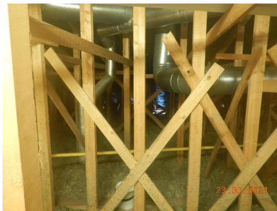
Kuva 83 Yläpohjatilassa havaittiin useampi ämpäri ilmeisesti vuotokohtien alla. Yläpohjatila tuulettuu räystäältä.
