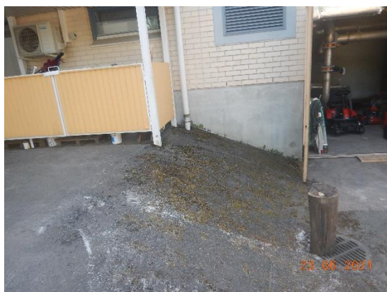
Kuva 12 Luiskan sivut ovat sammaloituneet.
