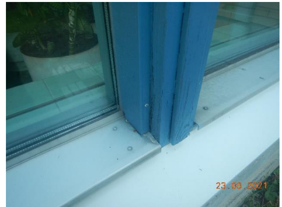
Kuva 47 Puuikkunoiden pinnat ovat osin kuluneet.
