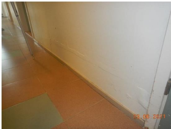
Kuva 73 Kosteusvauriojälkiä käytävän 248 väliseinässä.
