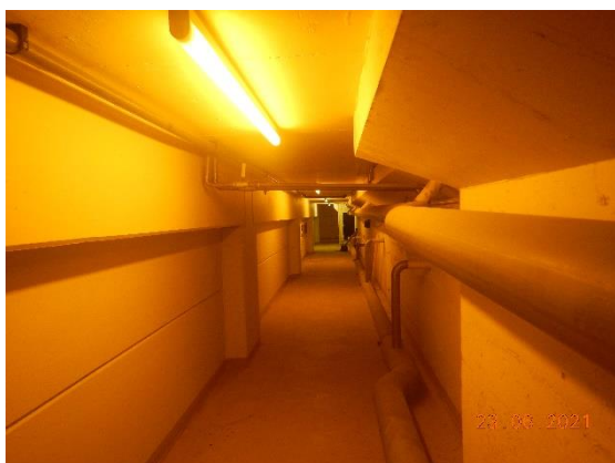
Kuva 54 Altaiden huoltokäytävillä näkyvät vauriot ovat allasrakenteissa. Maanpaineeseinät (kuvassa vasemmalla) ovat pääosin siistit.
