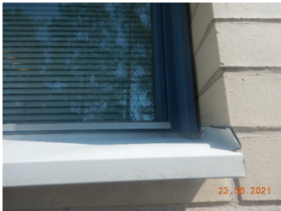
Kuva 48 Ikkunapeltien ja puitelistojen liittymät ovat paikoin epätiiviiit.
