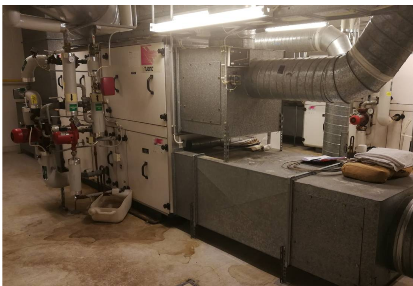
Kuva 9. Esimerkki IV-konehuoneessa sijaitsevista ilmanvaihtokoneista.
