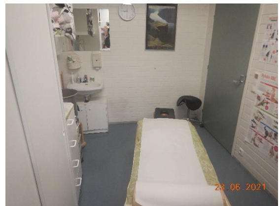
Kuva 35 Fysioterapeutin huoneen 253 lattia-reuna-alueella ja väliseinien alaosissa havaittiin kohonneita pintakosteuden vertailuarvoja. Tilan takana on pesutiloja.
