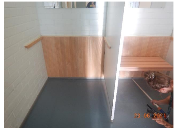
Kuva 74 Miesten pukuhuoneen 254 ja turkkilaisen saunan väliseinän alaosassa havaittiin kohonneita pintakosteuden vertailuarvoja.
