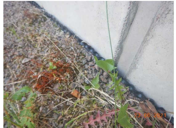
Kuva 30 Perusmuurin ulkopintaan paikoin lisätyn perusmuurilevyn yläreunasta puuttuu listä.
