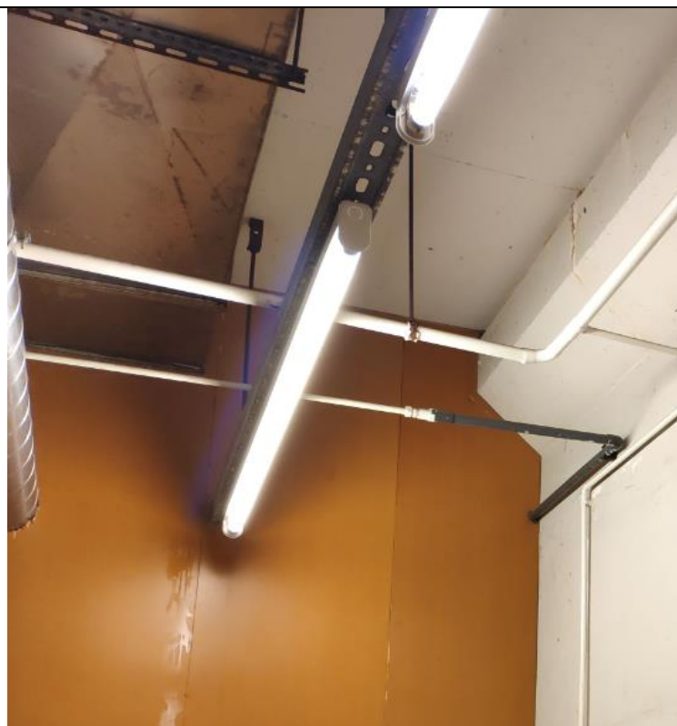
Valaisimien kuvut puuttuvat allaslaitetilassa
