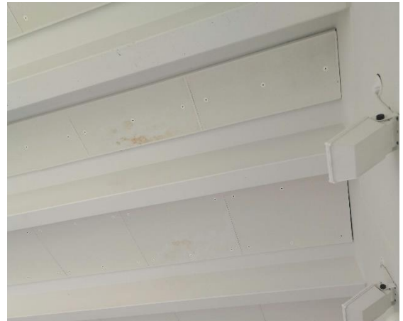
Kuva 88 TT-laatastojen sisäpintaan on kiinnitetty akustiikkalevyjä, joissa muutamissa on näkyvillä vauriojälkiä.
