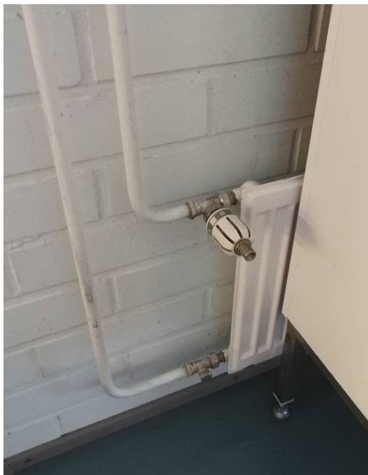
Kuva 3. Esimerkki radiaattorista termostaattiventtiileineen.
