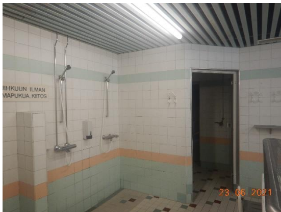
Kuva 75 Pesuhuoneiden väliseinissä havaittiin kauttaaltaan kohonneita pintakosteuden vertailuarvoja, mikä on normaalia laatoitetuissa märkätilapinnoissa.
