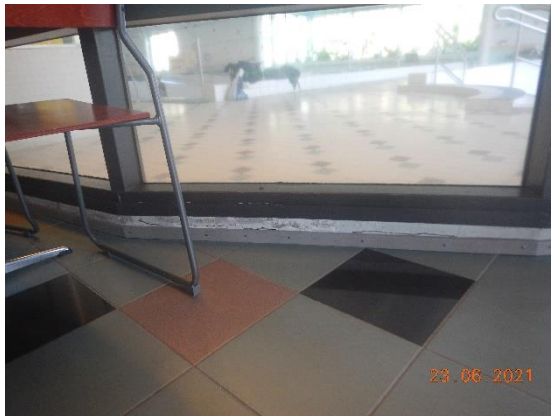
Kuva 71 Kosteusvauriojälkiä aulan ja allastilan välisen seinän alaosassa.
