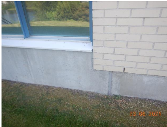
Kuva 46 Alempi vaalea pelti kaataa hyvin rakennuksesta pois päin.
