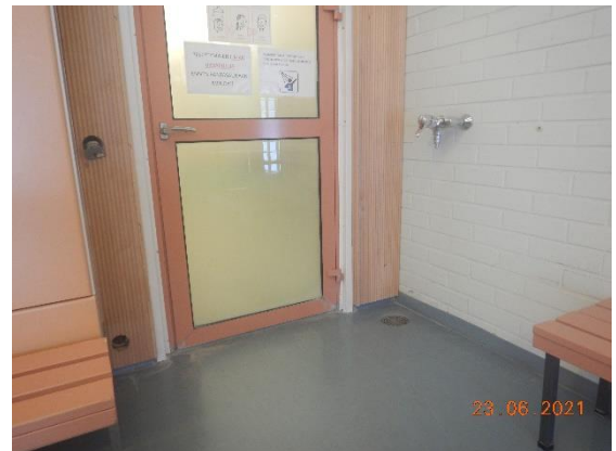
Kuva 33 Myös miesten pukuhuoneessa 254 jalkasuihkun luona havaittiin korkeita pintakosteusarvoja. Muovimaton ylösnosto ei ole tiivis, ks. seuraava kuva.
