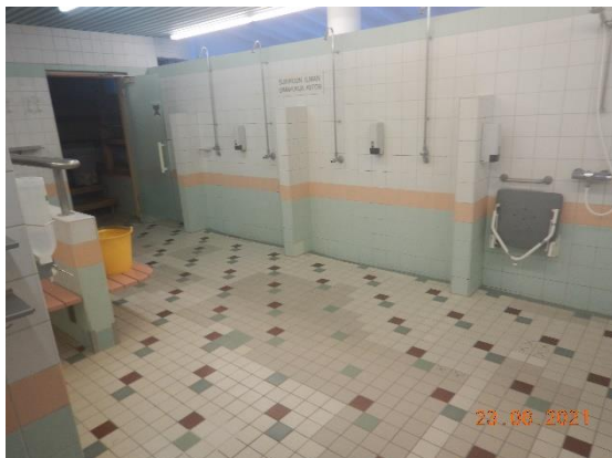
Kuva 65 Pesuhuoneissa väliseinissä on keraaminen laatoitus, joka on paikoin kulunut.
