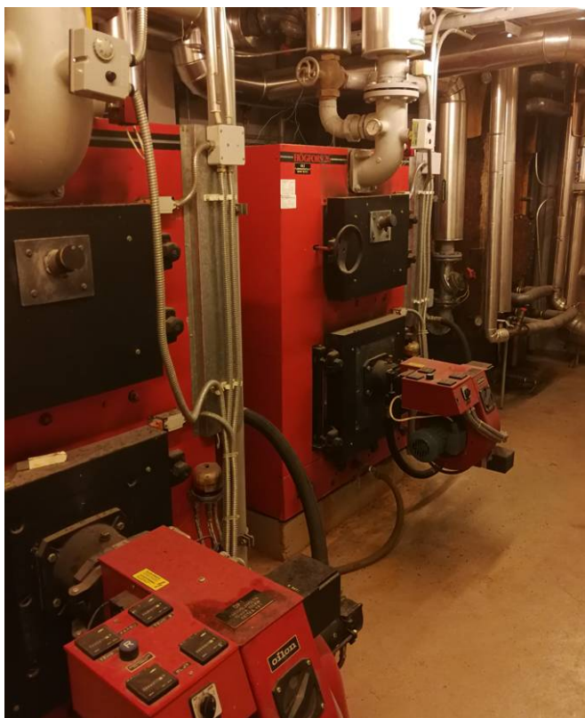
Kuva 1. Maakaasukattilat polttimiseen ja lämminvesivaraaja varusteineen.
