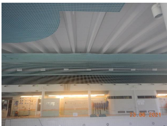
Kuva 89 Allasosaston alakattoverkon kannakointi on hieman notkahtanut.
