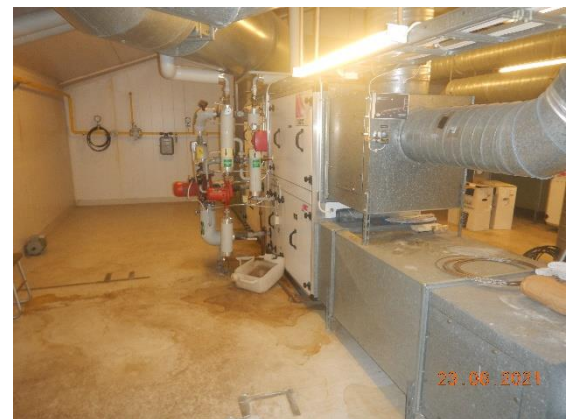
Kuva 70 IV-konehuoneen muovimatossa on paljon vuotojälkiä, likaa ja teippauksia. Aktiivisia vesivuotoja ei havaittu.
