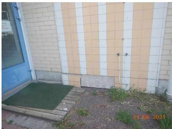
Kuva 44 Käytöstä poistetun ulkosuihkun laatoitus on huonokuntoinen. Osa laatoituksesta on pudonnut maahan.
