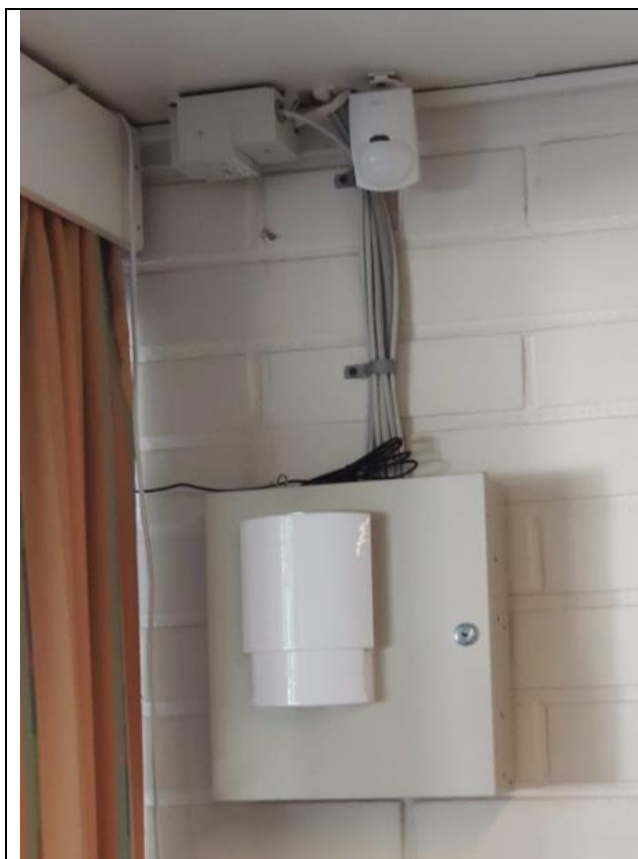
Murtoilmaisinkeskus ja PIR-tunnistin, henkilökunnan sos.tilassa
