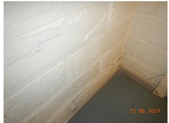
Kuva 72 Fysioterapeutin huoneen 253 väliseinissä on kosteusvauriojälkiä.
