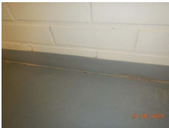
Kuva 34 Muovimaton ylösnoston taitekohta on haljennut ja vesi pääsee maton alle.
