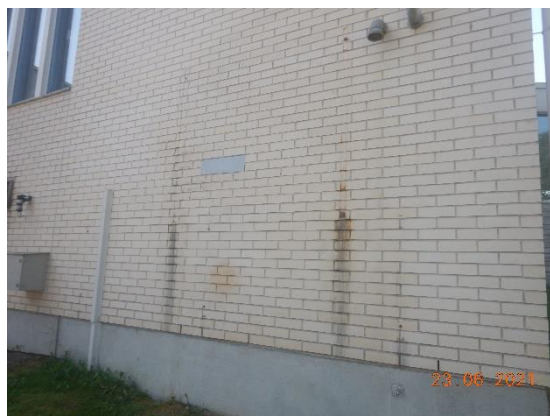
Kuva 43 Pohjoissivulla on muutamia valumavärjäytymiä.
