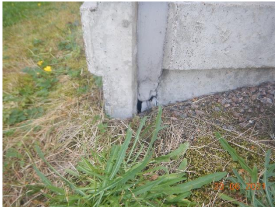
Kuva 29 Sokkelielementtien saumoissa on rakoilua ja elastinen saumamassa ei ulotu maanpinnan alapuolelle.
