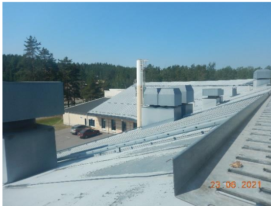
Kuva 85 Peltisen vesikatteen maalipinta on kulunut ja hilseilee. Taaimpana näkyvällä katto-osuudella vesikatteenä on bitumikermi.
