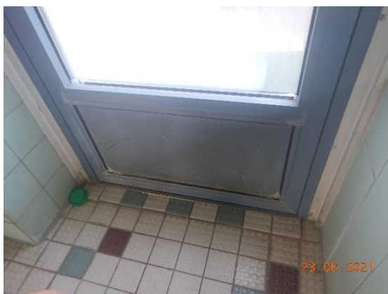
Kuva 50 Allasosaston ulko-ovi on huonokuntoinen.
