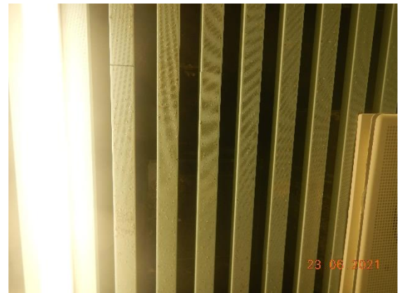
Kuva 94 Pesuhuoneiden alakatot ovat monin paikoin ruostuneet ja epäsiistit.
