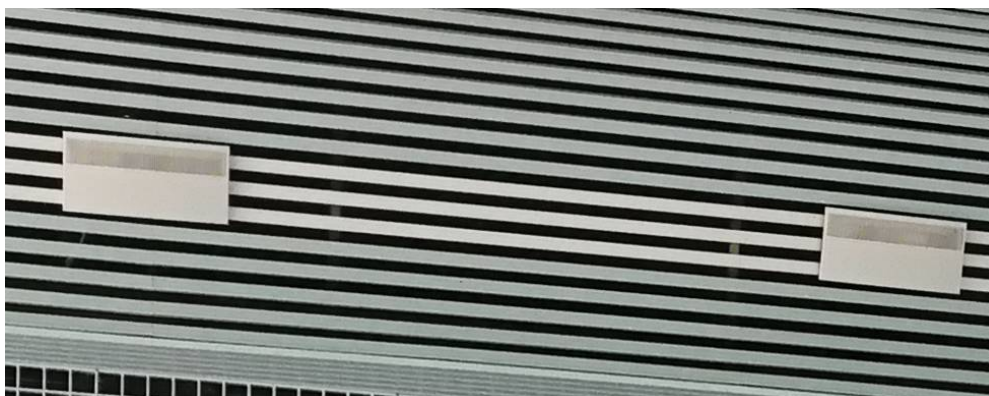
Kuva 12. Uimahallin poistoilman päätelaitteita.
