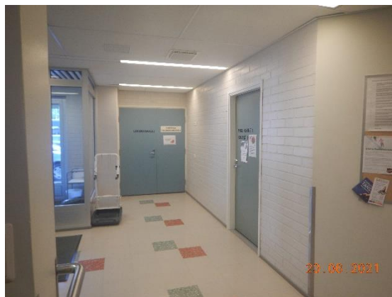
Kuva 69 Alakatoissa on akustiikkalevyt ensimmäisen kerroksen välipohjassa.
