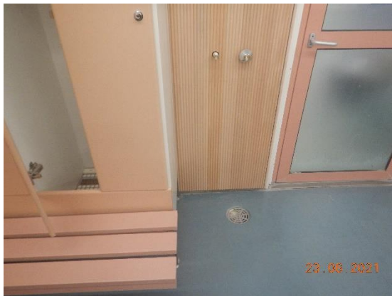
Kuva 32 Kohonneita pintakosteuden vertailuarvoja havaittiin pukuhuoneissa jalkasuihkujen luona. Kuva naisten pukuhuoneesta 260. Muovimatto on irti alustastaan.
