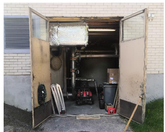
Kuva 51 Huoltotilan metalli-puu-rakenteiset ovet ovat kuluneet.
