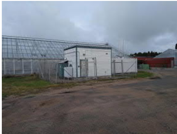
Kuva 1 Häkämäen nykyinen paineenvähennysasema
