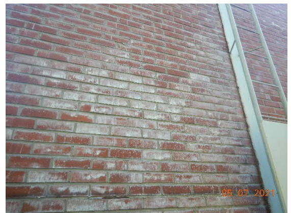
Kuva 49 Runsaasti kalkkihärmää luoteis-sivulla. Tiilimuurausta tukevien I-terästen reunat on ruosteessa.
