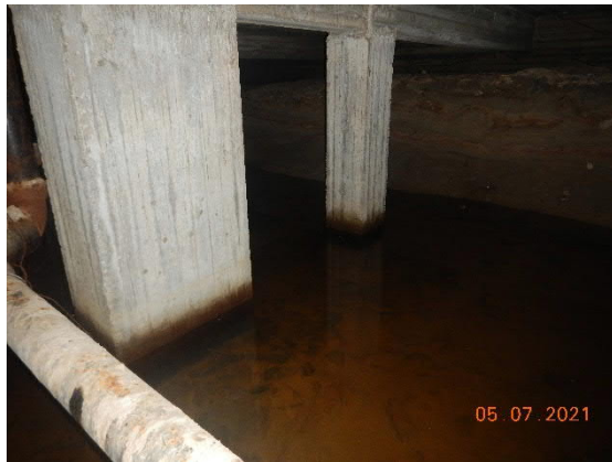
Kuva 22 Betonipilareiden alaosat ovat veden alla.
