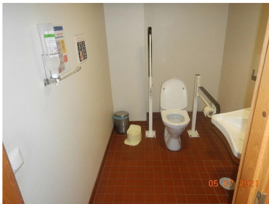
Kuva 93 Aulan wc-tiloissa välipohjassa havaittiin kohonneita pintakosteusarvoja.
