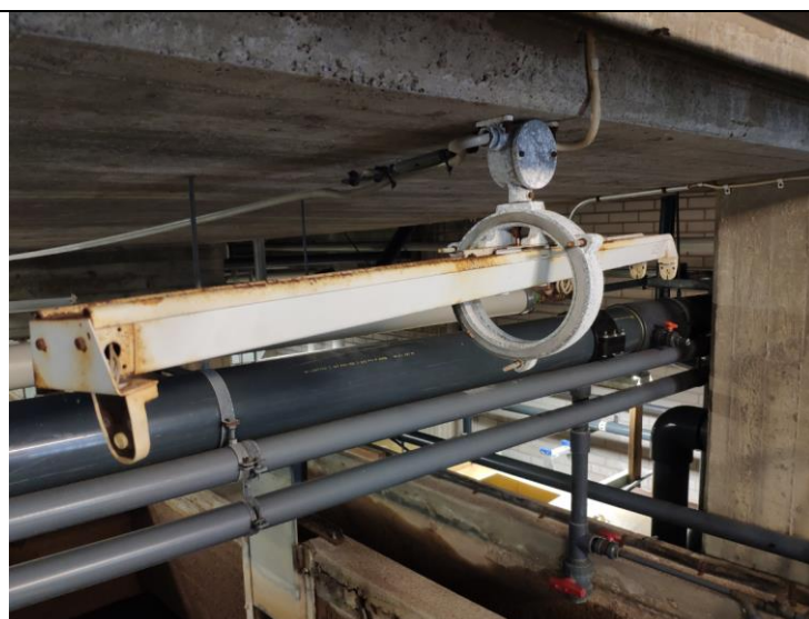
Käytöstä poistettu valaisin allaslaitetilassa
