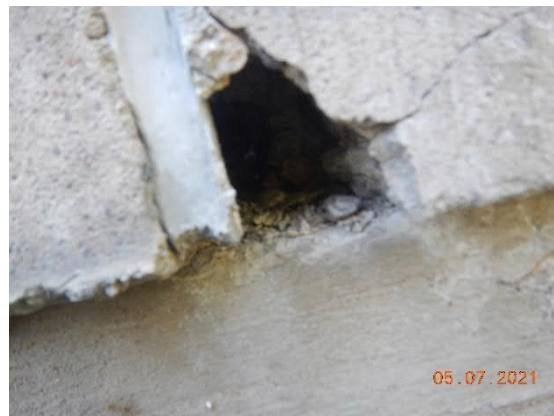
Kuva 17 Sokkelin ja tiiliseinän liittymässä halkeilua.
