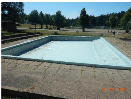
Kuva 10 Ulko-altaan reunalaatoitus on painunut ja saumat heinittyneet.
