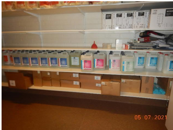
Kuva 35 Kohonneita pintakosteuden vertailuarvoja havaittiin siivousvarastossa 020.
