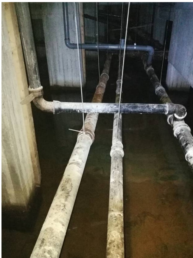
Kuva 6. Esimerkki valurautaviemäreistä tekniikkakerroksen alapuolella.
