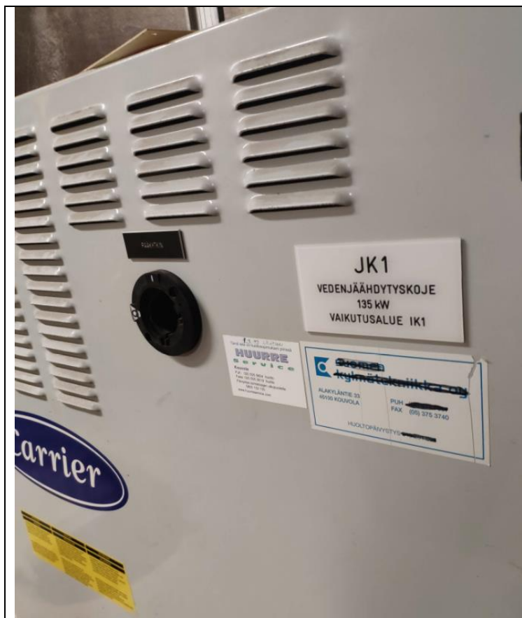
Jäähdytyslaitteiston pääkytkin on rikkoutunut
