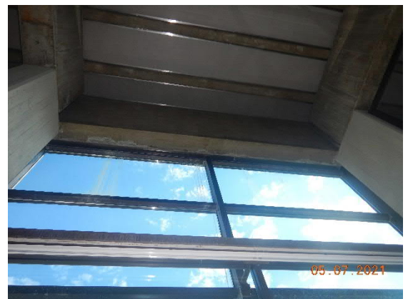
Kuva 61 Ikkunoissa ja niiden rakenteissa on runsaasti valumajälkiä.
