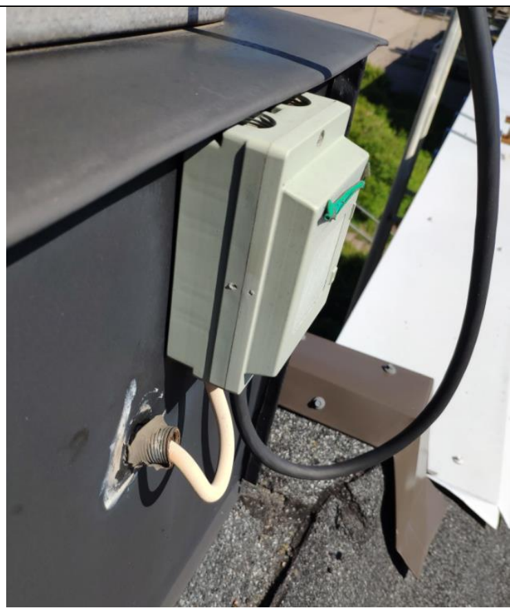
Huippuimurin kaapelin läpivienti ei ole tiivis
