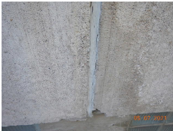
Kuva 54 Elastiset saumamassat ovat kovettuneet ja halkeilevat.
