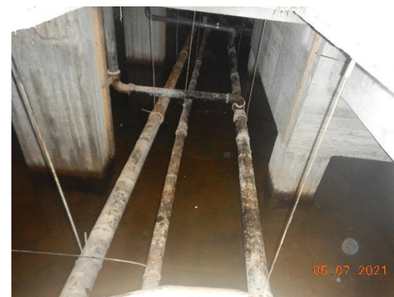
Kuva 21 Alapohjatilassa on runsaasti vaapaata vettä, jonka vuoksi rakenteita ei päästy tarkastamaan.
