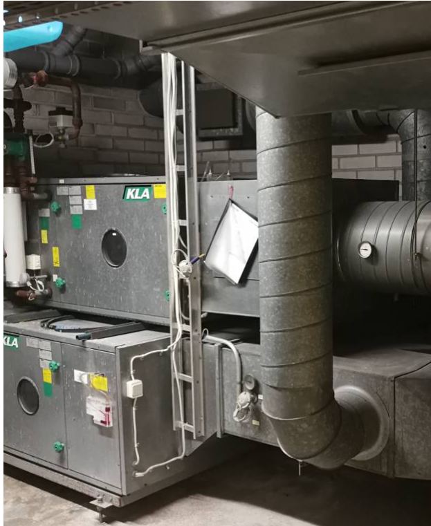
Kuva 10. Esimerkki IV-konehuoneessa sijaitsevista tuloilmakoneista.
