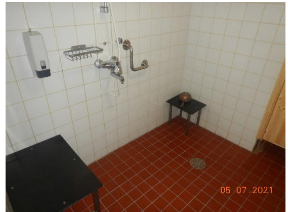
Kuva 92 Tilaussaunojen pesuhuoneissa havaittiin kohonneita pintakosteusarvoja.
