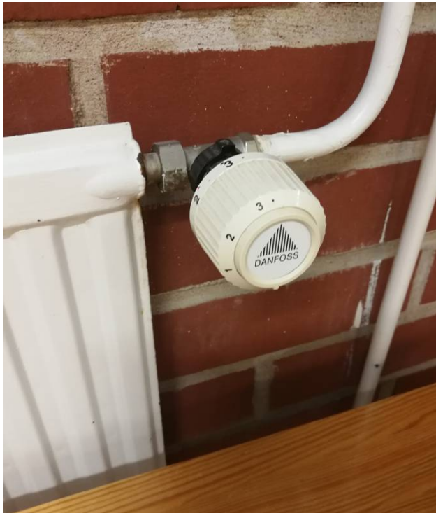
Kuva 3. Esimerkki radiaattorista termostaattiventtiileineen.
