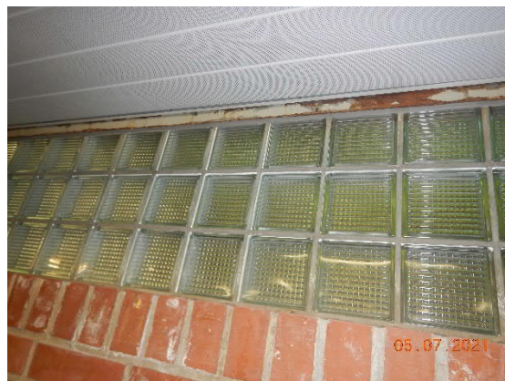
Kuva 63 Lasitiili-ikkunoiden teräsrakenteissa on ruostetta myös sisätiloista tarkastellen.
