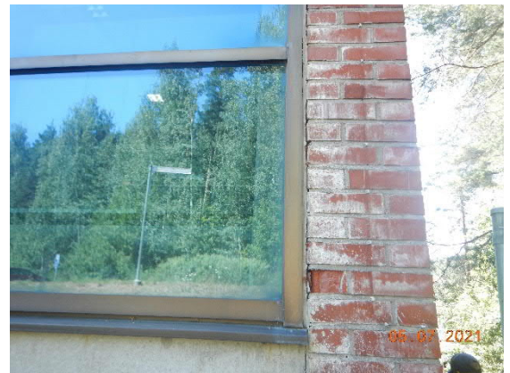
Kuva 55 Ikkunoiden ja ulkoseinien liittymät ovat epätiivit.
