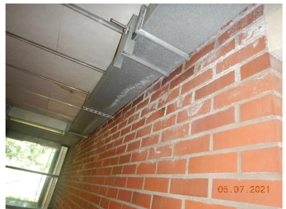
Kuva 86 Kalkkeutumaa tiiliväliseinässä allasosaston ja luoteisen porraskäytävän välillä.
