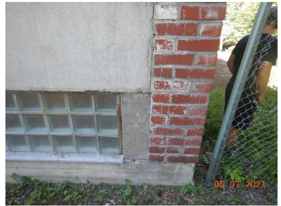
Kuva 53 Pukuhuonekerroksen lasitiili-ikkunoiden teräsrakenteet ovat ruosteiset.
