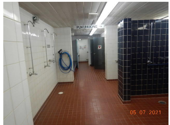
Kuva 94 Pesuhuoneissa havaittiin kohonneita pintakosteuslukemia.
