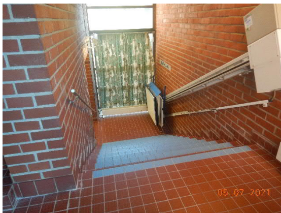
Kuva 95 Kaakkoissivulla allasosastolta lähtevässä portaikossa havaittiin kohonneita pintakosteusarvoja.
