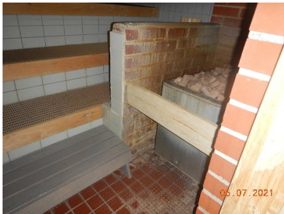
Kuva 83 Saunojen pintamateriaalit ovat kuluneet.
