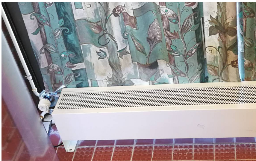
Kuva 4. Esimerkki konvektorista termostaattiventtiileineen.
