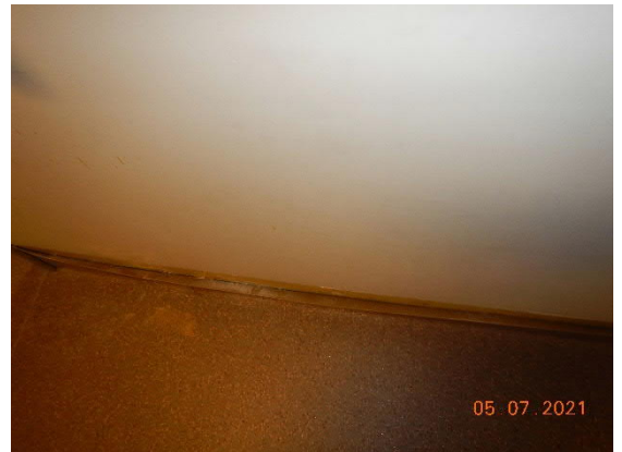
Kuva 36 Muovimatto on korkannut irti reunoistaan.
