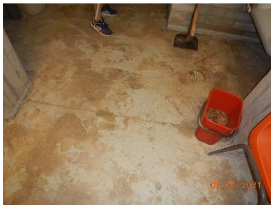
Kuva 26 Maalipinta on paikoin kulunut.
