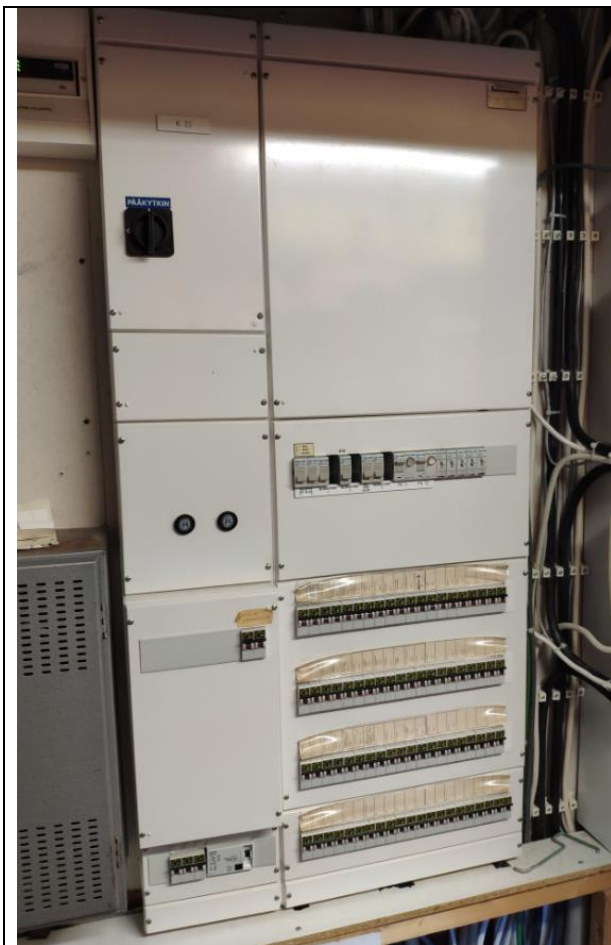
Uimavalvojan tilassa olevan jakokeskuksen kosketussuojaus puutteellinen.
