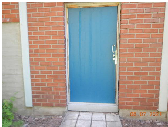
Kuva 58 Ulko-ovet ovat välttävässä kunnossa. Teräsrakenteissa on ruostetta.
