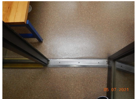
Kuva 31 Muovimatto on irti alustastaan ryhmäpukuhuoneen kynnyksellä.
