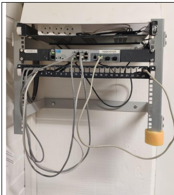
Yleiskaapeloinnin ristikytkentäteline henkilökunnan taukutilassa
