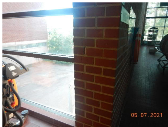
Kuva 65 Kaakkoissivun portaikon luona seinäpäädyssä on pientä halkeilua.
