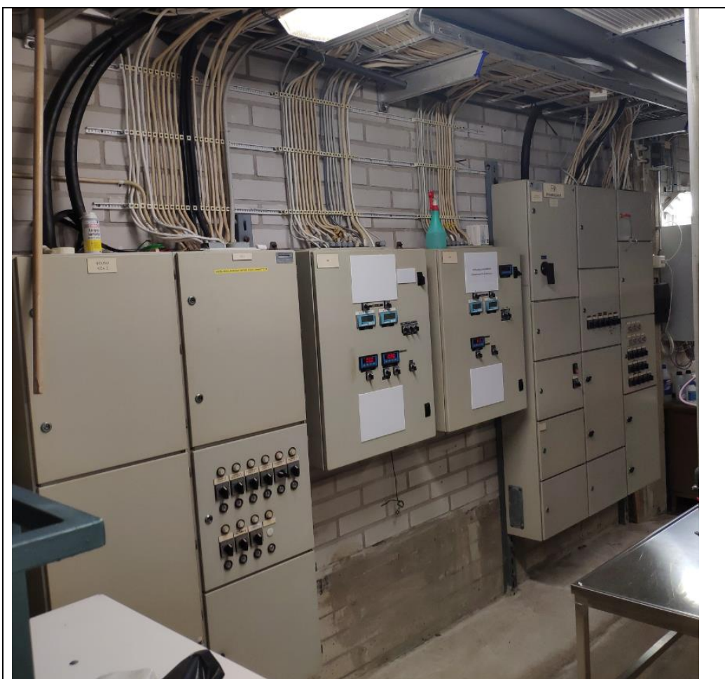
Allaslaitetilan jakokeskuksia ja kiinteistöautomaatiokeskuksia.
