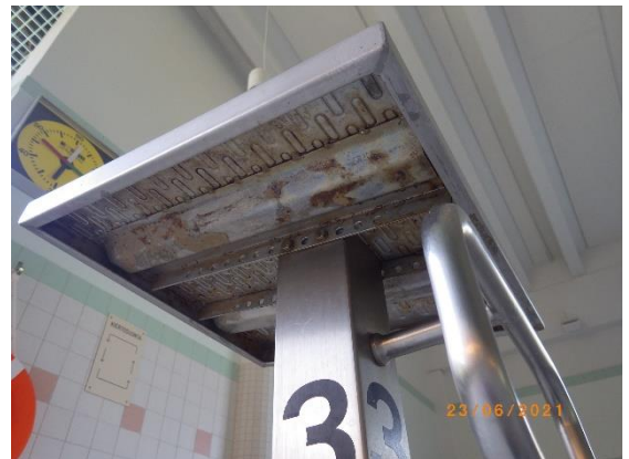
Kuva 41 Hyppytaidoissa havaittiin korroosiota.
