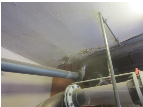
Kuva 31 Allasrakenteissa havaittiin vuotojälkiä.
