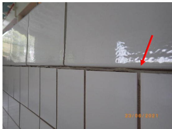
Kuva 15 Loiskekourun ja seinälaatoituksen välinen sauma rakoili.
