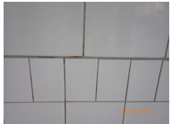
Kuva 28 Seinässä havaittiin yksittäisiä ruostejälkiä.
