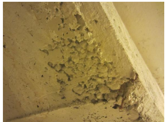
Kuva 23 Seinän yläosassa havaittiin paikoin betonin olevan huonosti tiivistynyttä valun aikana.
