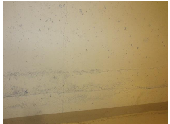
Kuva 21 Seinissä havaittiin yksittäisiä halkeamia.
