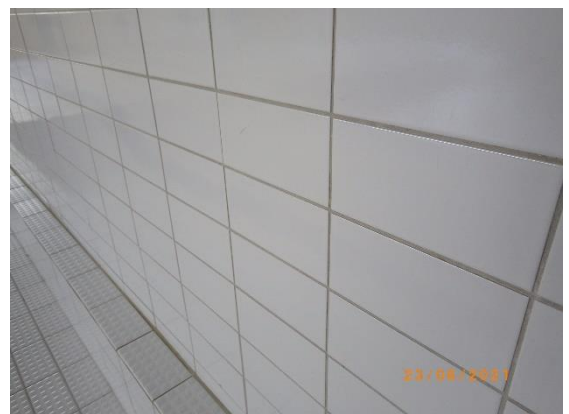
Kuva 13 Lattioiden ja seinien saumat olivat pääasiassa hyvässä kunnossa.
