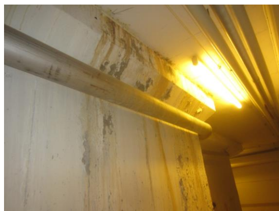
Kuva 19 Seinissä havaittiin vuotojälkiä
