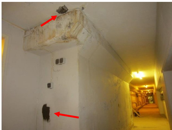
Kuva 22 Seiniin on tehty yksittäisiä paikakorjauksia.
