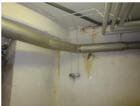
Kuva 18 Seinissä havaittiin vuotojälkiä.
