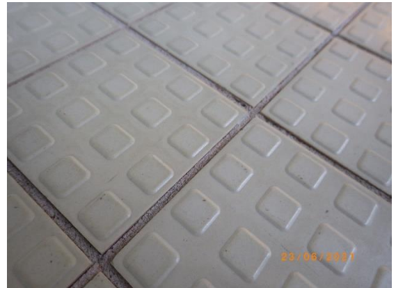
Kuva 39 Saumat olivat laaja-alaisesti kuluneita. Osa saumoista oli uusittuja/täytettyjä.
