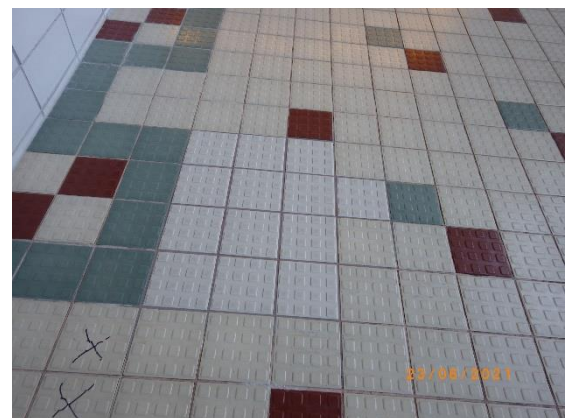
Kuva 37 Lattialaatoituksia on uusittu monissa kohdissa allastilan puolella.
