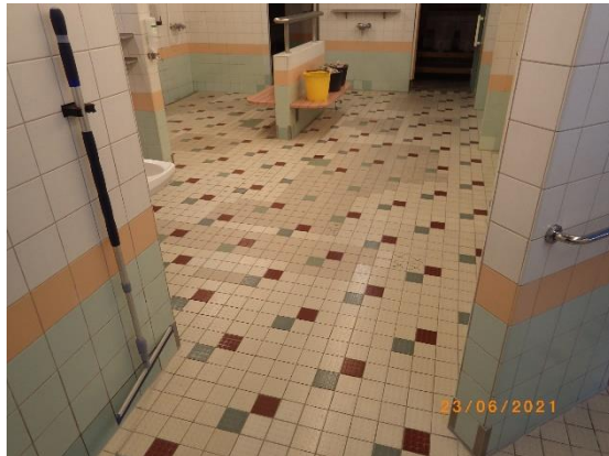
Kuva 38 Lattialaatoituksia on uusittu monissa kohdissa suihkutilojen puolella.
