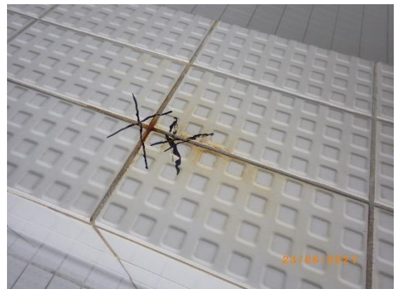
Kuva 11 Seinissä havaittiin yksittäisissä kohdissa ruostejälkiä. Ruostekohdissa oli myös paikoin kopoa.
