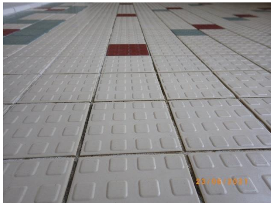
Kuva 40 Saumat olivat laaja-alaisesti kuluneita. Osa saumoista oli uusittuja/täytettyjä.
