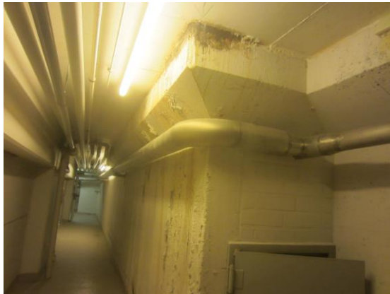
Kuva 20 Seinissä havaittiin vuotojälkiä
