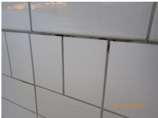
Kuva 27 Loiskekourun ja seinän välinen sauma oli halkeillut ja paikoin avoin.
