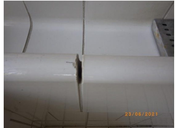
Kuva 26 Loiskekourun sauma oli useassa kohdassa avoin.
