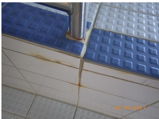
Kuva 12 Seinissä havaittiin yksittäisissä kohdissa ruostejälkiä.
