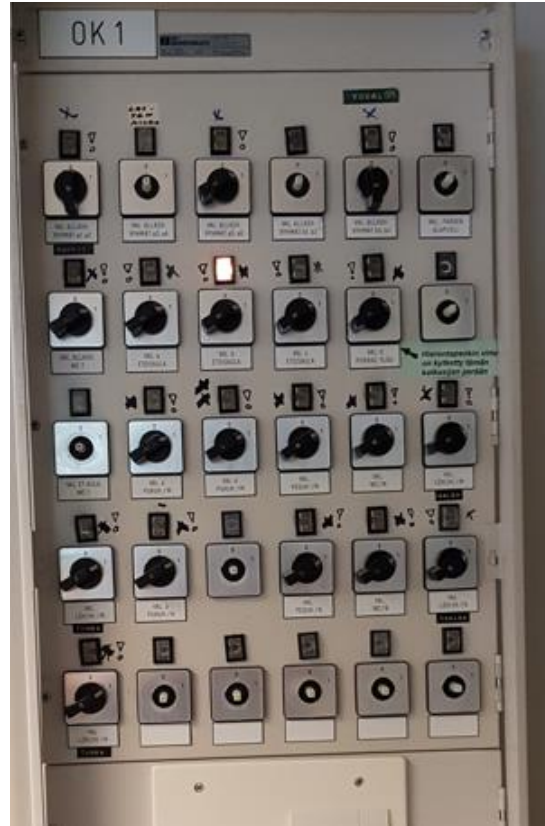
Kuva 138. Valaistuksen ohjauskeskus: merkkilamppuja pimeänä ja ohjausmerkinnät sekavia
