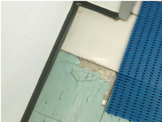
Kuva 70. Lohkeilua lattian vinyylilaatituksessa
