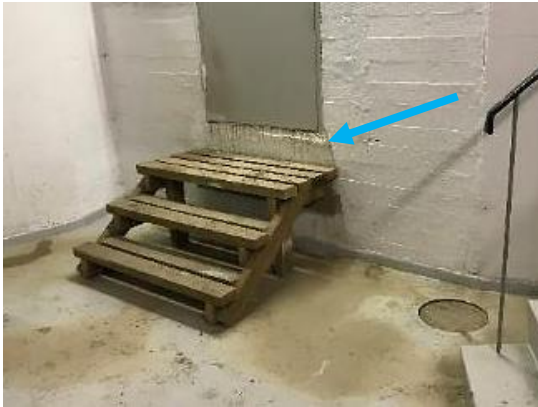
Kuva 3. Valumavedet kulkeutuvat ryömintätilasta viereiseen IV-konehuoneseen p20
