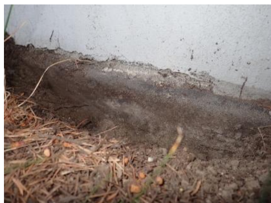
Kuva 41. Sokkelin laastipinnoituksen ja vedeneristeen liittymä ei ole suunnitelmien mukainen
