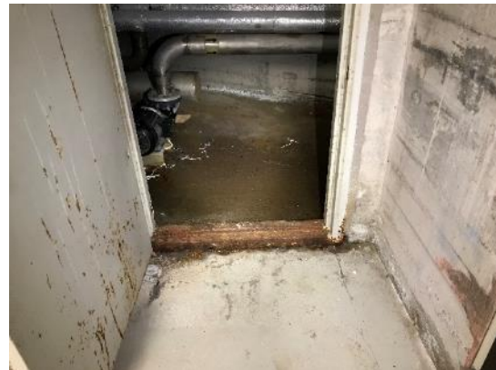
Kuva 6. Vettä ryömintätilaan johtavan huoltokäytävän lattialla
