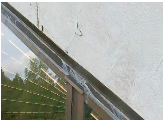
Kuva 54. Valumajälkiä allashuoneen kaari-ikkunan yläpeitelistan takaa
