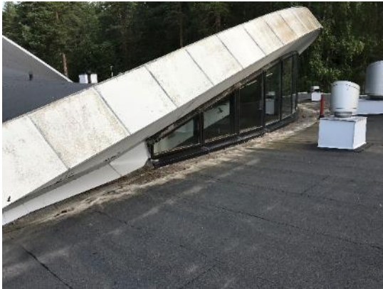
Kuva 108. Vesikatto kallistaa ikkunaseinää päin
