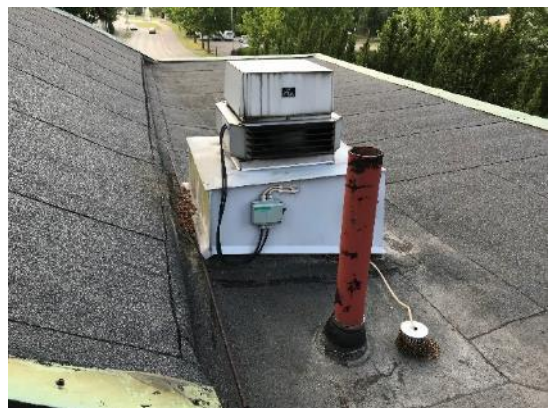
Kuva 113. Viereisen kuvan 112 kohta vesikatolta kuvattuna
