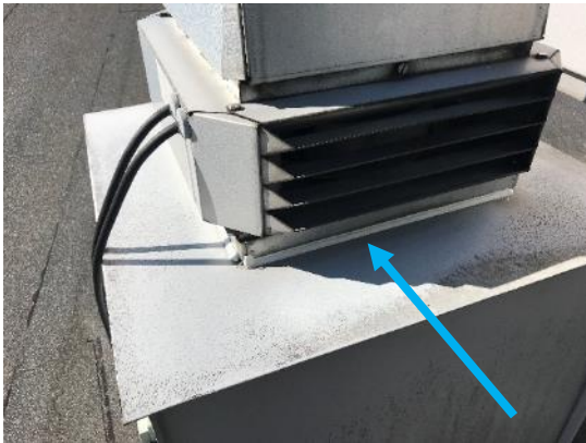
Kuva 110. Ilmanvaihtolaitteen tiivistetty sauma
