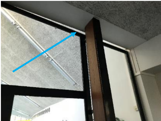
Kuva 58. Allashuoneen ja portaikon välisen lasiseinän epätiivieyskohtia
