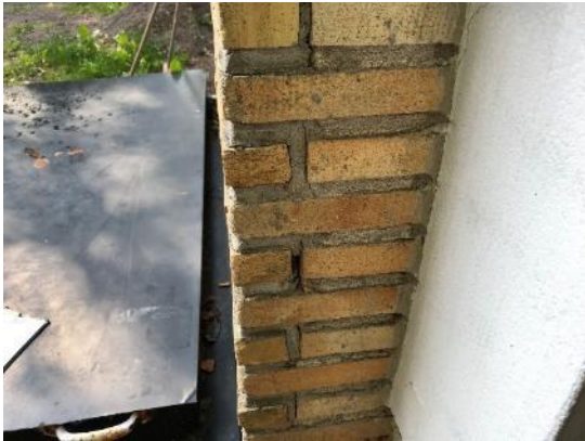
Kuva 24. Rapautunutta tiilimuurauksen laastisaumoissa
