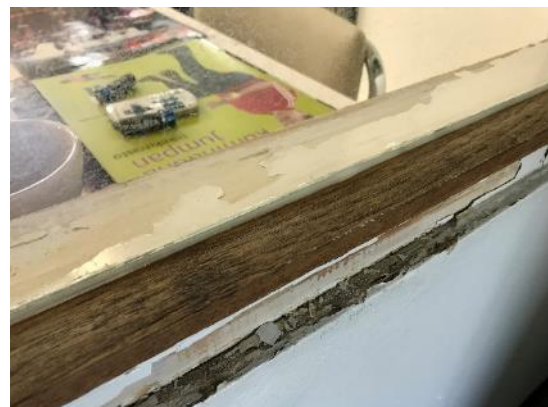
Kuva 83. Kosteuden aiheuttamia vaurioita taukotilan sisäikkunan ja väliseinän rakenteissa, yläaula p02B
