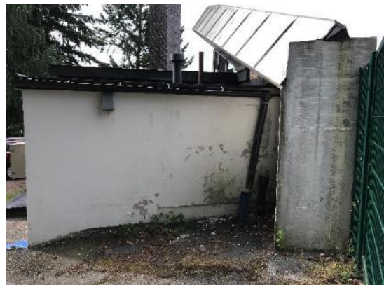
Kuva 29. Betonisen ulkoseinän pinnoitevaurioita kemikaalivaraston kohdalla
