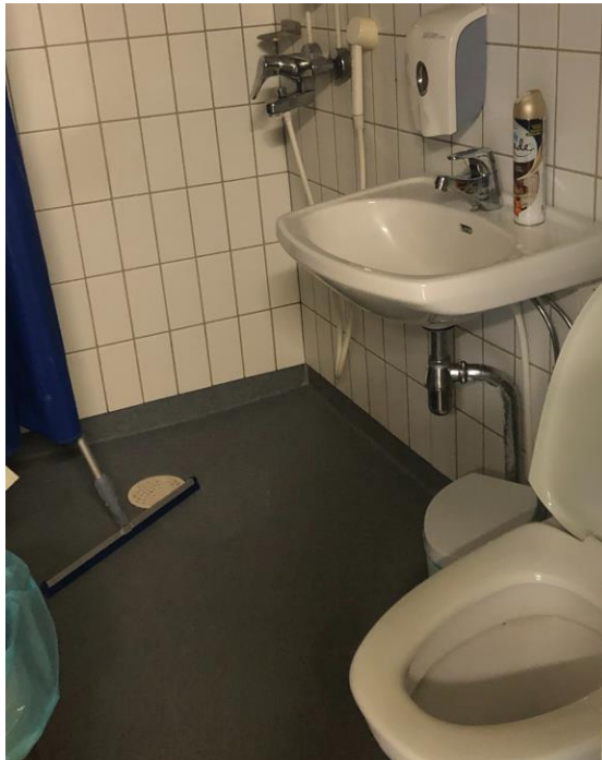
Kuva 132. Sosiaalitilojen vesi- ja viemärikalusteita
