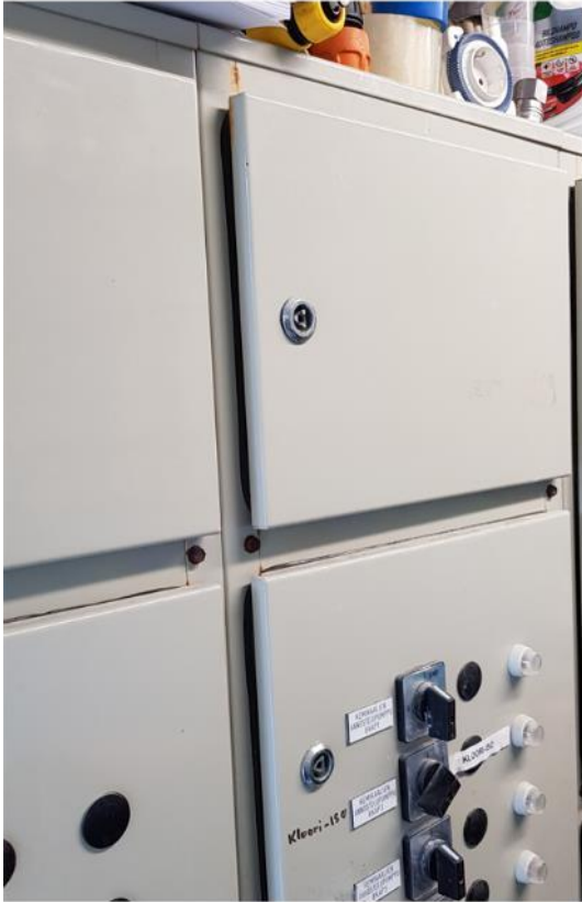
Kuva 137. Keskuksen päälle kasaantunutta ylimääräistä tavaraa ja alkava korroosioaurio
