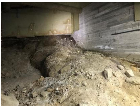
Kuva 7. Valumavesien aiheuttamia uurteita maapohjassa
