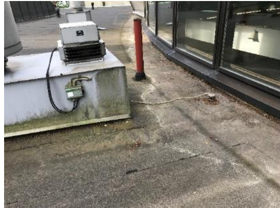
Kuva 109. Vesikaton ja ikkunakarmin välinen korkeusero on pieni
