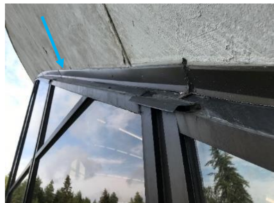
Kuva 55. Allashuoneen kaari-ikkunan yläpeitelistan ja betonikaaren liittymä on epätiivis
