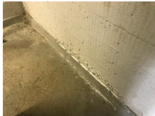
Kuva 87. Kosteuden aiheuttamia pinnoitevaurioita väliseinän alaosassa, IV-konehuone p16
