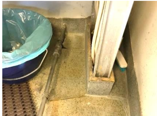
Kuva 71. Epätiivitä saumoja muovimattopinnoitteessa, siivouskomero 106
