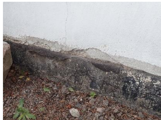
Kuva 16. Maanvastaisen seinän vedeneristeenä oleva bitumisively on kulunut
