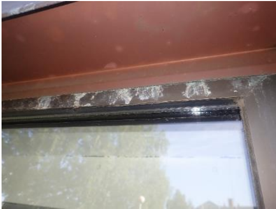
Kuva 50. Valumajälkiä ikkunan yläpellityksen alta
