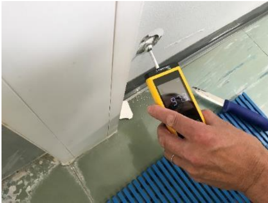
Kuva 84. Pienialainen kostea kohta käytävän 111 väliseinässä
