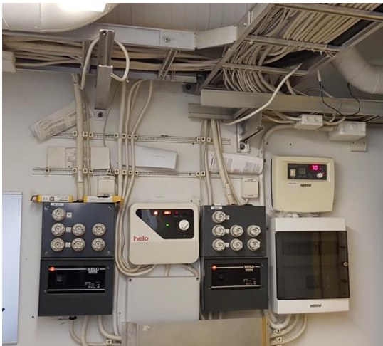
Kuva 147. Saunan ohjauskeskukset: kaapeleita kiinnittämättä, vedonpoisto irtokaapeleita hyllyllä eikä niitä ole päätetty
