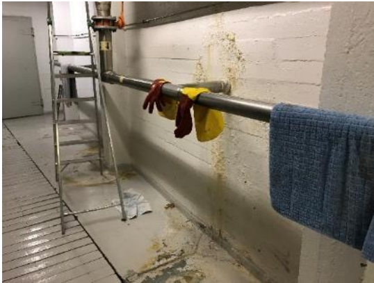
Kuva 90. Vuotokohtia ison altaan syvän päädyn seinässä, tekniset tilat
