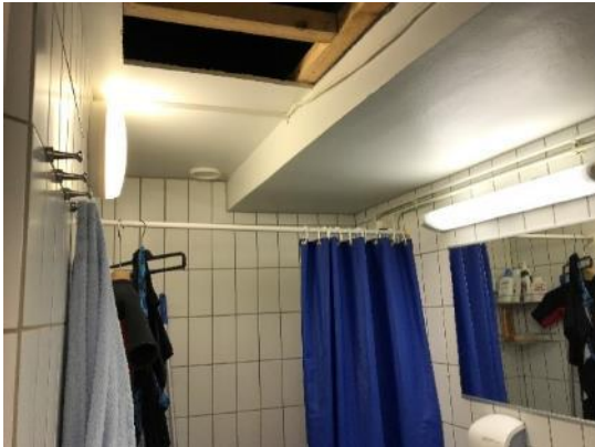
Kuva 74. Alakattotilan levytyksessä suuri avoin aukko, wc 118
