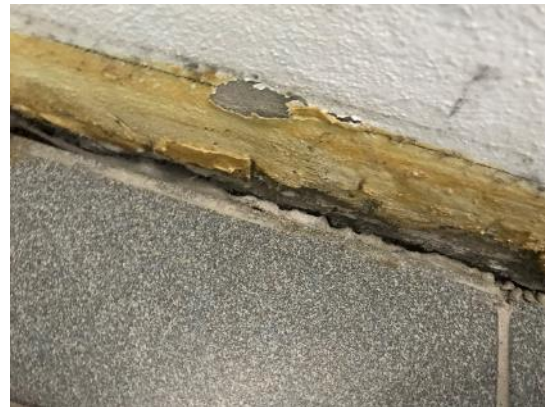
Kuva 12. Epätiivis alapohjan ja ulkoseinän välinen liittymä, eteisaula p02
