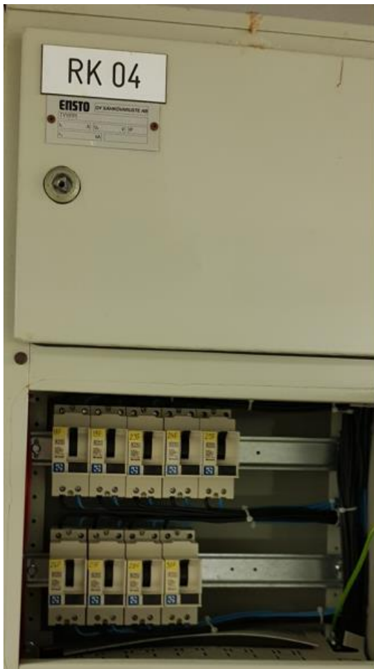
Kuva 139. Keskuksesta puuttuu sormisuoja kojeiden päältä
