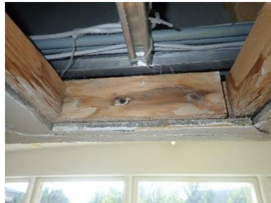
Kuva 115. Vanha kosteusvauriokohta alakattotilassa, naisten pukuhuone 105
