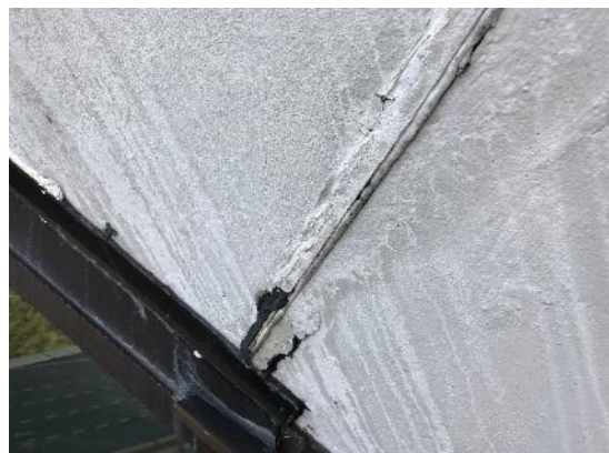
Kuva 35. Betonikaaren saumojen saumamassat ovat kovettuneita ja saumojen kohdilla on lohkeamia
