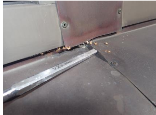
Kuva 51. Epätiivis vesipellityksen liittymä
