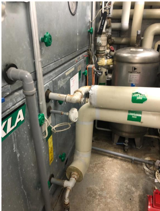
Kuva 133. Ilmanvaihtokone 4TK01, lämpöjohtoja eristeineen sekä käyttövesisäiliö.
