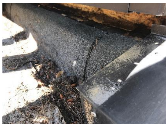
Kuva 49. Allashuoneen matalan kaari-ikkunan kohdalla on epätiivis ulkoseinäliittymä vesipellin alla
