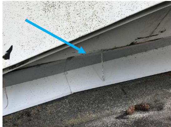
Kuva 105. Epätiivis pellityksen tiivistys
