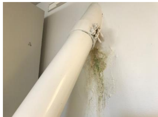
Kuva 77. Vuotokohta opetusaltaan ja miesten pukuhuoneen p04 välisessä seinässä
