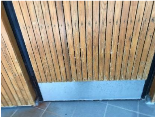
Kuva 62. Kosteusjälkiä allashuoneen välioiven lakatussa puupanelointipinnassa
