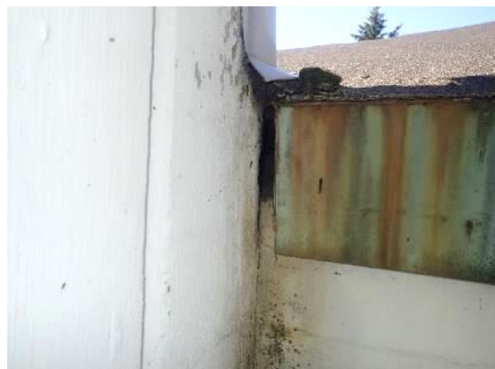
Kuva 107. Epätiivis liittymän räystääpellissä
