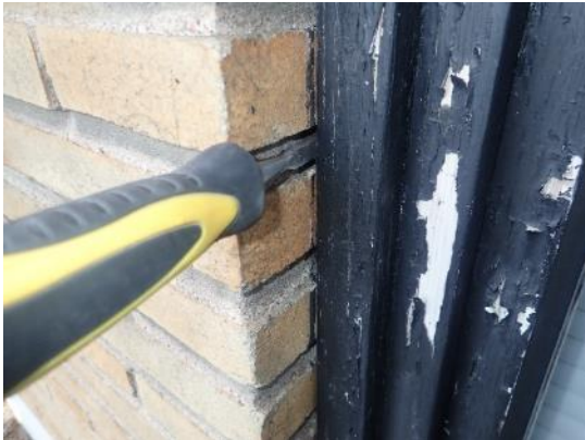
Kuva 44. Epätiivis ulko-oven liittymä ulkoseinään
