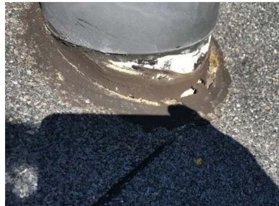
Kuva 97. Epätiivis alipainetuulettimen läpiviennin tiivistys
