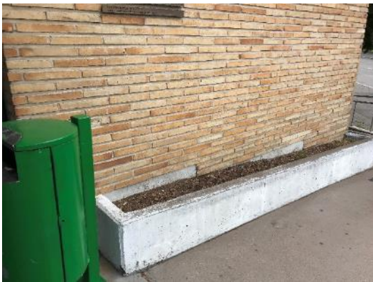
Kuva 38. Betoninen kasvikaukalo lisää rakenteisiin kohdistuvaa kosteusrasitusta
