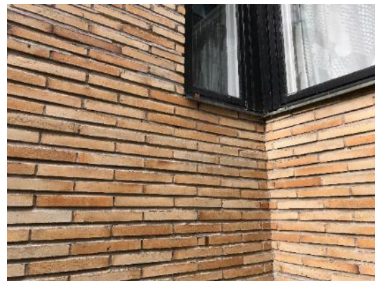
Kuva 23. Rapautuneita laastisaumoja julkisivun tiilimuurauksessa
