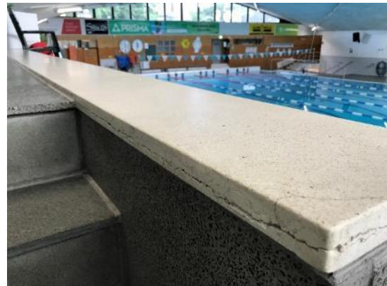
Kuva 127. Lohkeamiamja halkeamia katsomon kivipenkissä
