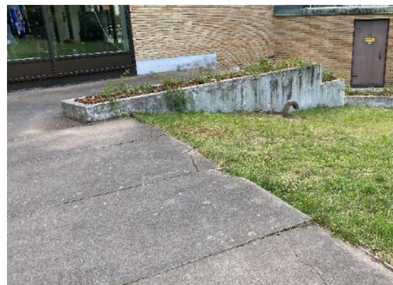
Kuva 121. Värjäymiä betonisen istutusaltaan pinnoilla
