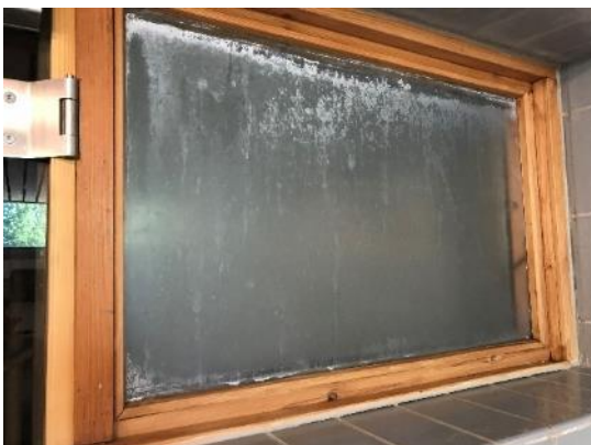
Kuva 60. Epäsiisti saunan sisäikkunan lasi, miesten sauna
