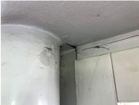
Kuva 56. Eteläseinän nauhaikkunoiden väliset peltipeitteiset liittymät ovat epätiivaitä
