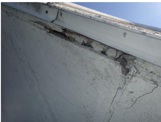
Kuva 34. Lohkeamia betonissa betonikaaren ja räystäspellin liittymässä
