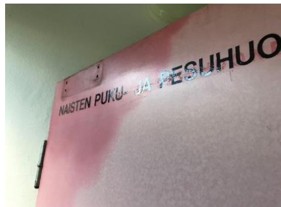
Kuva 61. Pinnaltaan haalistunut väliovi
