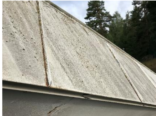
Kuva 103. Jäkäläkasvustoa ja korroosiota räystääpellissä
