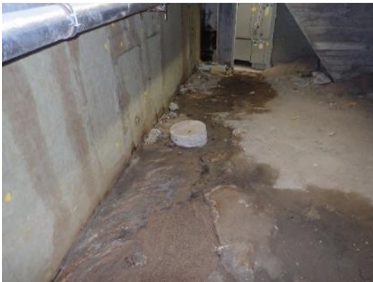
Kuva 5. Kosteus- ja mikrobivaurioituneita eristevillalevyjä ryömintätilan seinässä
