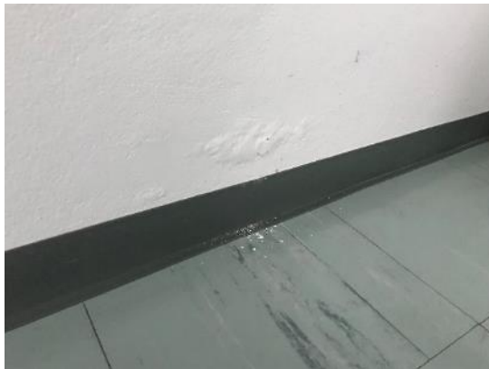
Kuva 13. Porrashuoneen p13 maanvastaisen seinän kosteusvauriokohta
