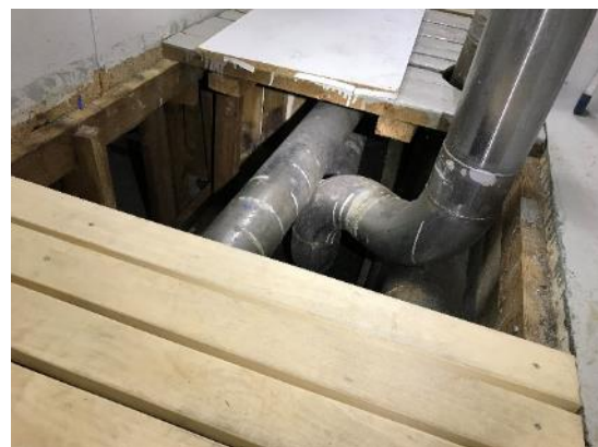
Kuva 20. Kanaalien sisäpuolella on kosteusvaurioituneita puurakenteita.
