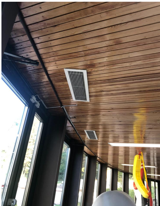
Kuva 134. Allashuoneen ilmanvaihdon päätelaitteita
