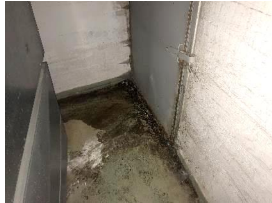
Kuva 10. Kuilun luukku, jonka kautta valumavedet kulkeutuvat IV-konehuoneeseen k06A
