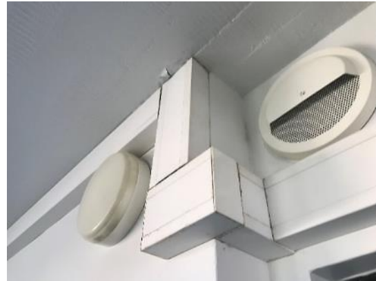
Kuva 85. Valumajälkiä kaapelikoteloiden pinnoilla, 111 käytävä
