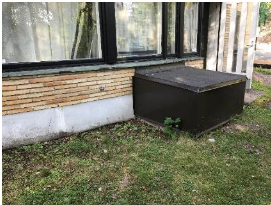
Kuva 11. Valumavedet kulkeutuvat IV-konehuoneeseen k06A rakennuksen seinustalla olevan kuilun kautta
