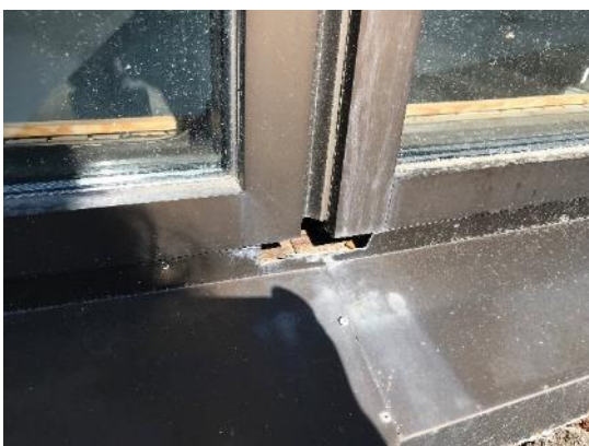
Kuva 48. Epätiivis kohta allashuoneen matalan kaari- ikkunan vesipellityksessä
