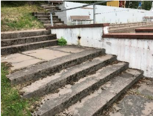
Kuva 122. Sammalkasvustoa betoniportaiden pinnoilla
