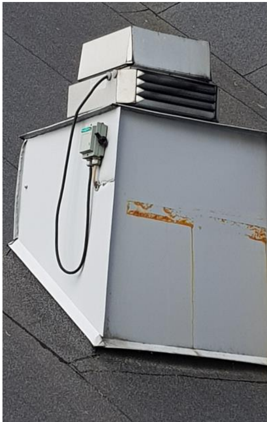
Kuva 140. Turvakytkimen lippa puuttuu kytkimen päältä
