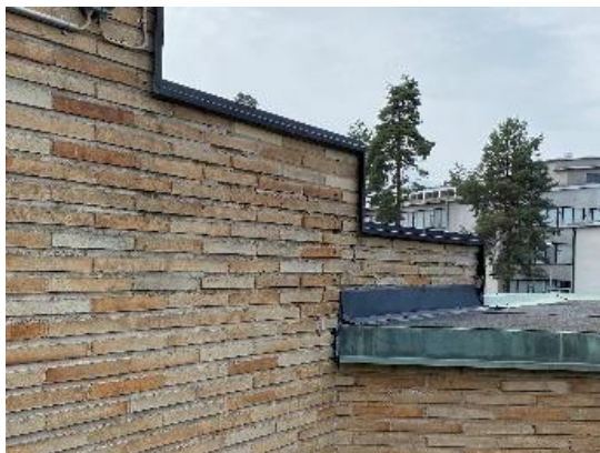
Kuva 22. Rapautuneita tiilimuurauksen laastisaumoja
