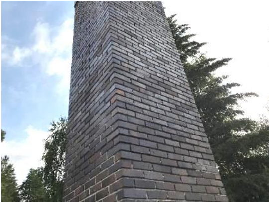
Kuva 26. Tiilimuuratun hormin yläosassa laastisaumat rapautuneita
