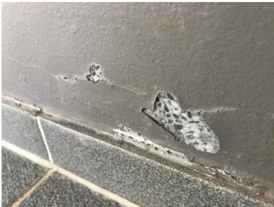
Kuva 126. Katsomopenkin korjatun pinnoitteen lohkeamakohta
