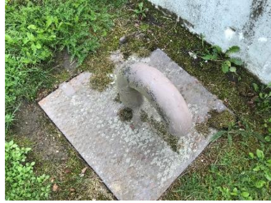
Kuva 18. Hätäpoistumistunnelin luukun saranat ovat epäkunnossa.
