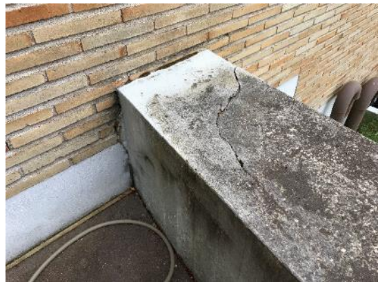
Kuva 39. Betonikaiteen päädyn kohdalla halkeamia betonissa ja epätiivis liittäminen ulkoseinään
