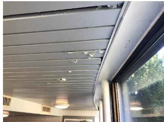
Kuva 65. Pesuhuoneen p06 alakaton metallipaneelien hilseilevää maalipinnoitetta
