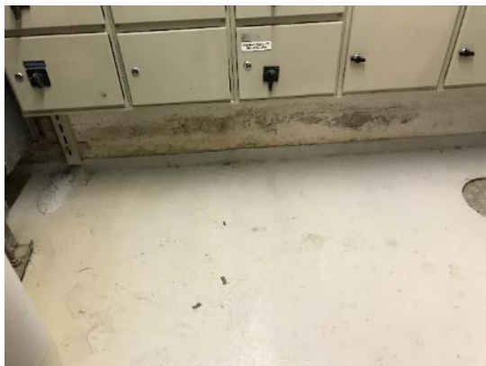
Kuva 15. Kosteuden aiheuttamia pinnoitevaurioita alaseinässä, IV-konehuone p20
