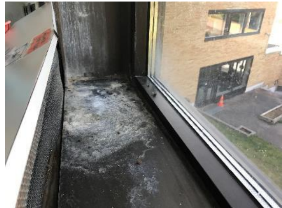
Kuva 53. Valumajälkiä allashuoneen ikkunapuitteissa
