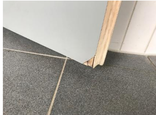
Kuva 63. Pieni lohkeama välioiven pinnoitteessa
