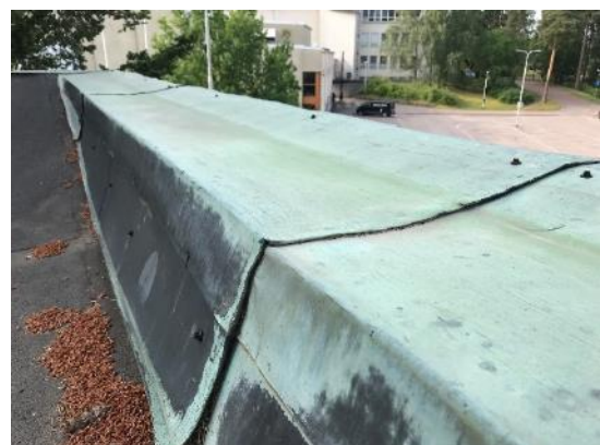
Kuva 101. Koveran räystääspeltien saumat ovat epätiiviviä
