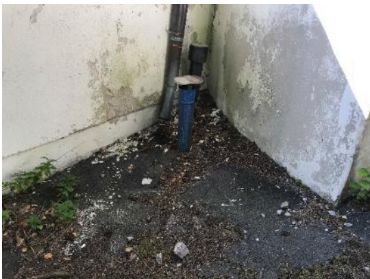
Kuva 28. Syöksyputki ei ohjaa kattovesiä riittävän kauan ulkoseinärakenteesta
