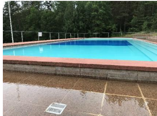
Kuva 119. Kahluualtaan betonilaatat ovat kuluneita
