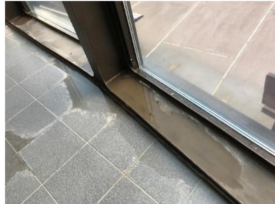
Kuva 75. Allashuoneessa siivousvedet jäävät seisomaan lattialla ikkunaseinän teräsrakenteiden viereen
