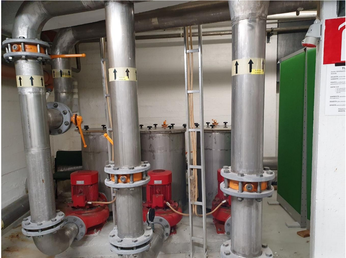
Kuva 2 Karkeasuodattimet ja kiertovesipumput.
