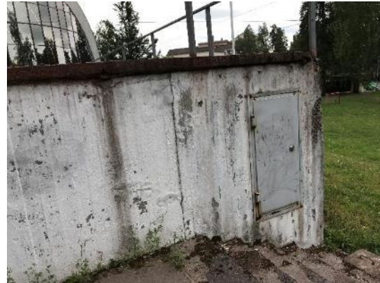
Kuva 123. Ulkoaltaan seinässä pinnoitevaurioita, värjäymiä ja lohkeamia
