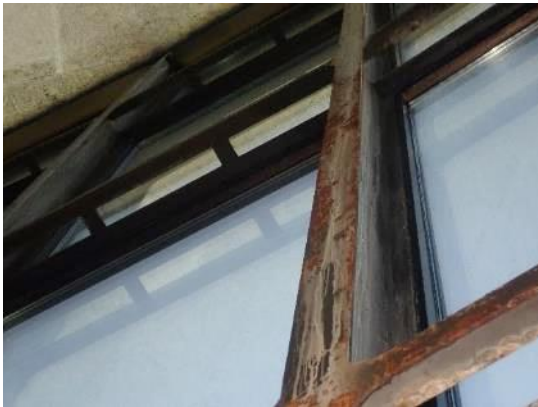
Kuva 52. Valuma- ja korroosiojälkiä allashuoneen ikkunoiden teräsrakenteissa
