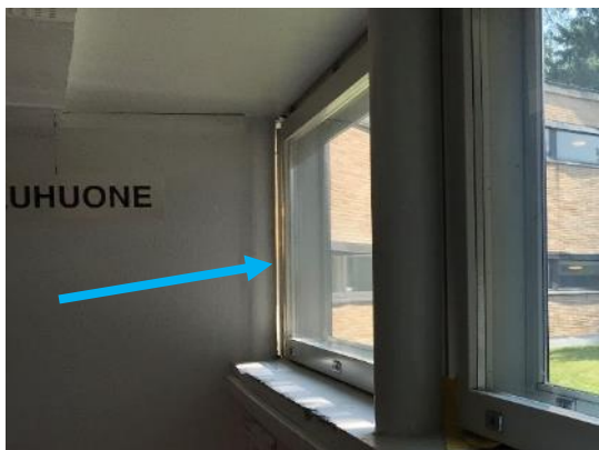
Kuva 76. Rakko väliseinän ja ulkoseinän liittymässä, eteisaula p02
