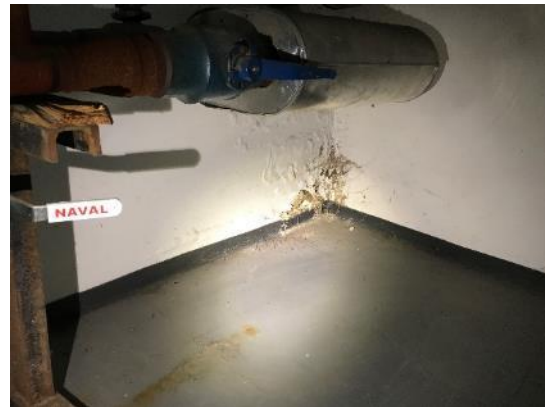
Kuva 14. Kosteuden aiheuttama vanha pinnoitevaurio, porrashuone p17
