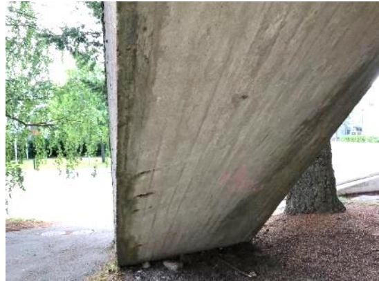
Kuva 37. Näkyviä raudoitteiden korroosiovaurioita betonikaaren alapinnalla
