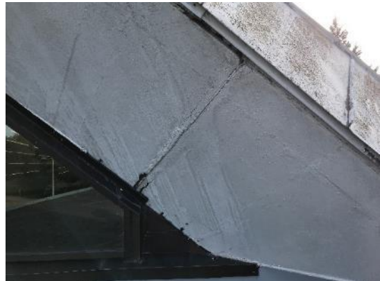
Kuva 33. Epätiivis betonikaaren sauma
