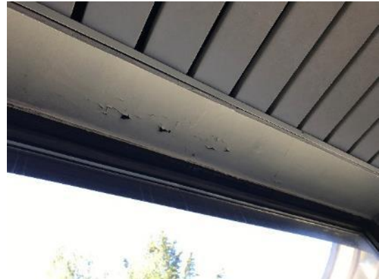
Kuva 57. Ikkunapielen hilseilevää maalia, p06 PH/M
