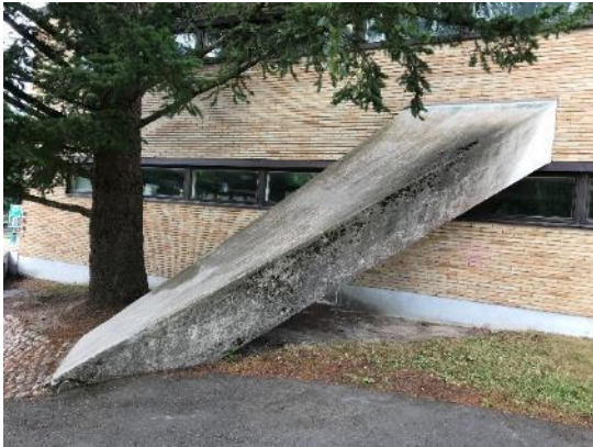
Kuva 36. Betonikaaren pinnalla värjäymiä ja sammalkasvustoa
