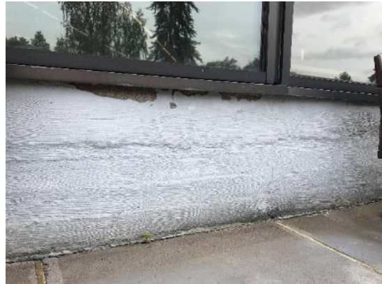
Kuva 31. Lohkeamia allashuoneen korkean ikkunan alapuolen sokkelissa
