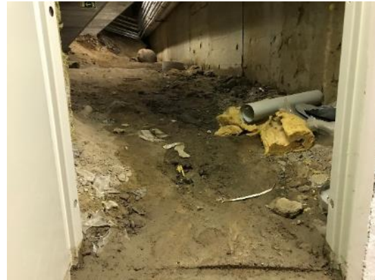
Kuva 4. Ryömintätilassa maapohjan päällä kosteus- ja mikrobivaurioitunutta rakennusjätettä
