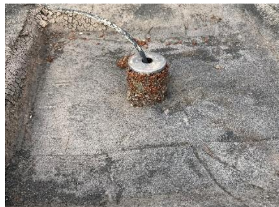
Kuva 95. Roskasta tukkeutunut kattokaivon siivilä
