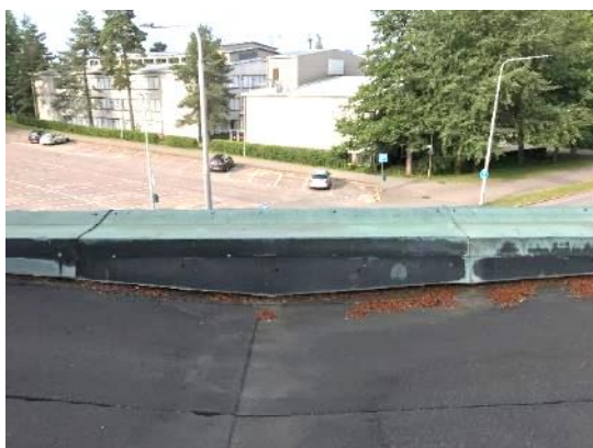
Kuva 100. Pääsisäänkäynnin kohdalla kovera räystääspelti
