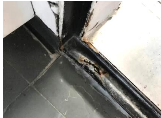
Kuva 59. Korroosiovaurioita kynnyksessä ja ovenpielessä
