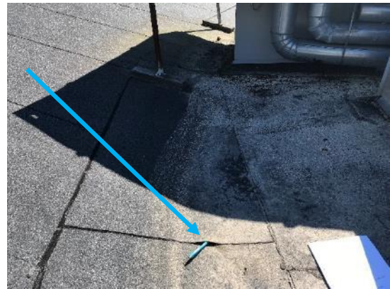
Kuva 93. Yksittäinen epätiivis vesikatteen saumakohta
