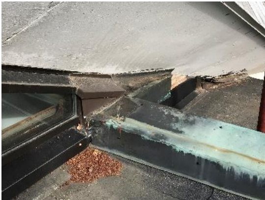
Kuva 104. Epämääräisiä ja epätiivitä liittymiä pellityksissä
