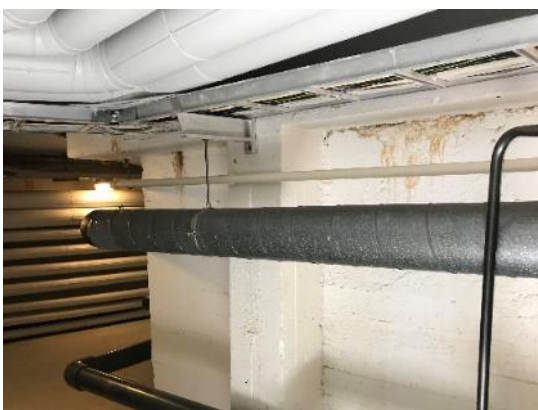
Kuva 88. Vuotokohtia ison altaan matalan päädyn kohdalla, tekniset tilat
