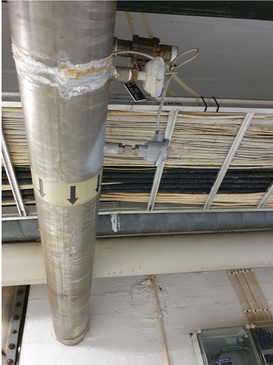
Kuva 7 Kemikaaliletkut kulkevat sähköhylyllä ilman suoja putkea. Toisinaan rikkihappoletku häpertuu ja vuotaa.
