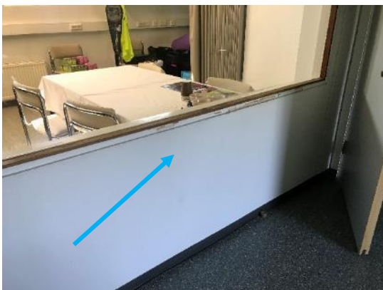
Kuva 82. Kosteusvauriokohta väliseinässä, yläaula p02B
