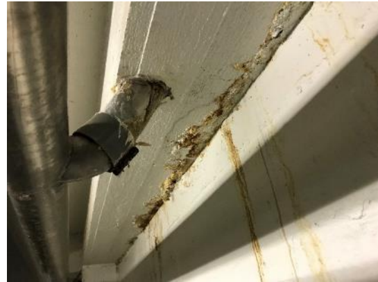
Kuva 91. Vuotokohtia ison altaan pitkällä sivulla, tekniset tilat
