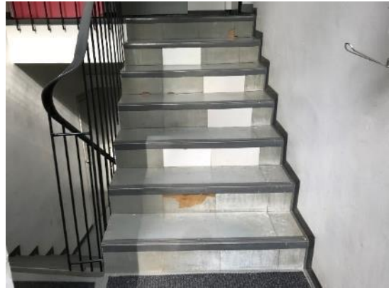
Kuva 69. Rikkinäisiä vinyylilaattoja, porrashuone p17
