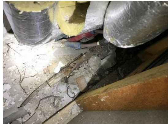
Kuva 81. Koteloinnin sisäpuolella olevaa rakennusjätettä, varasto käytävän p11 vieressä
