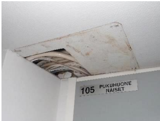
Kuva 114. Kosteusjälkiä alakattotilassa, yläaula p02B
