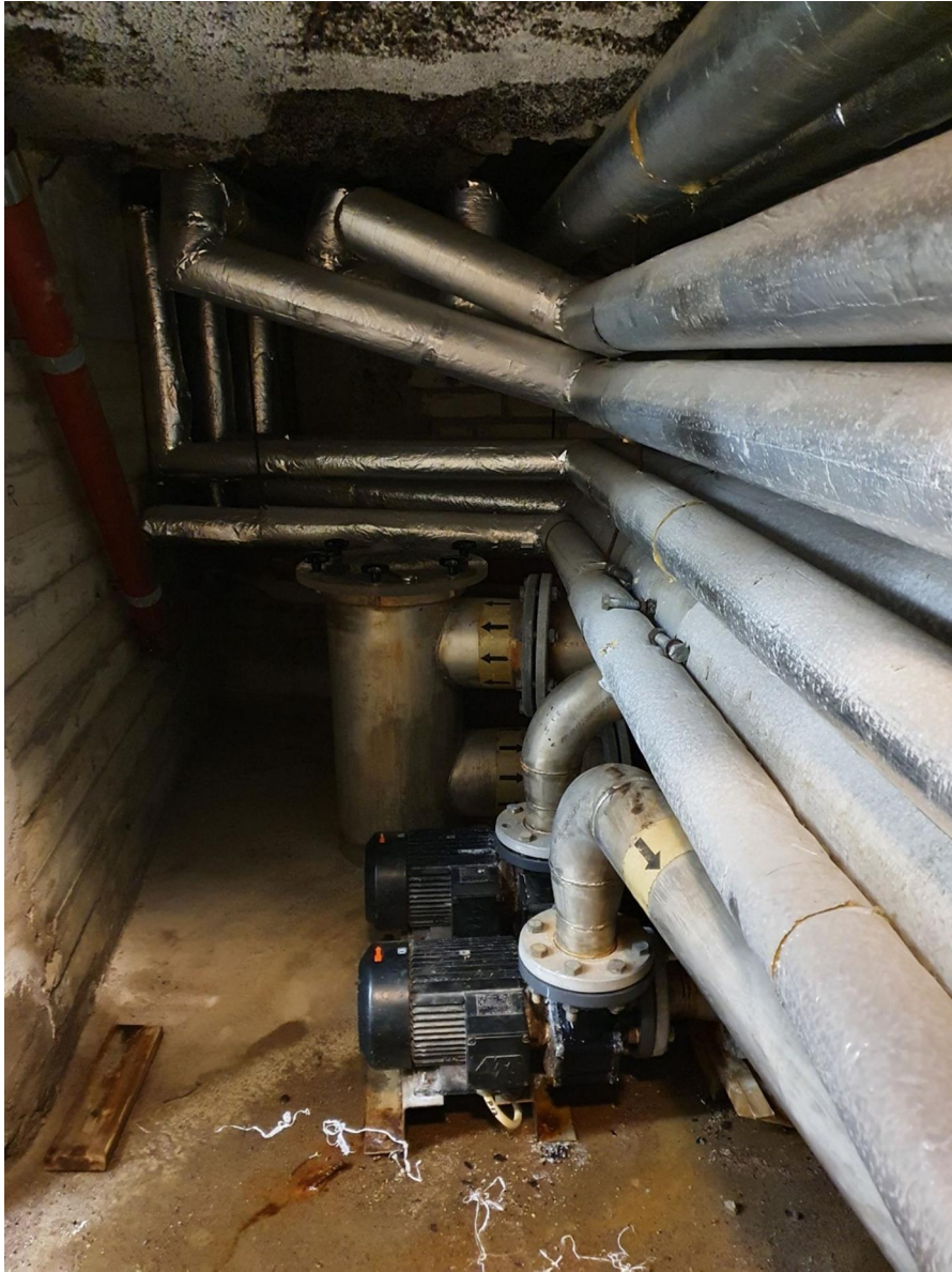
Kuva 6 Ison altaan vesitehosteiden pumput.
