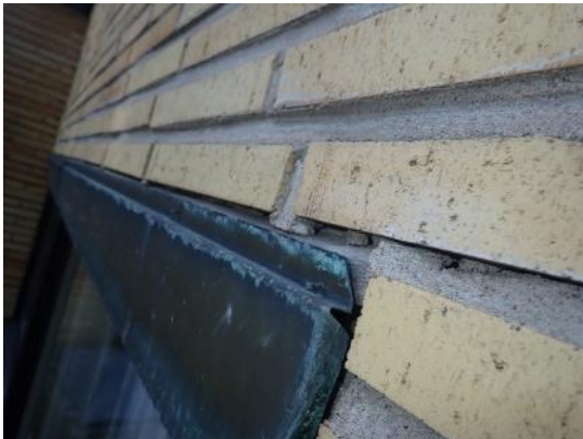
Kuva 46. Epätiivis ikkunan yläpuolen pellitys
