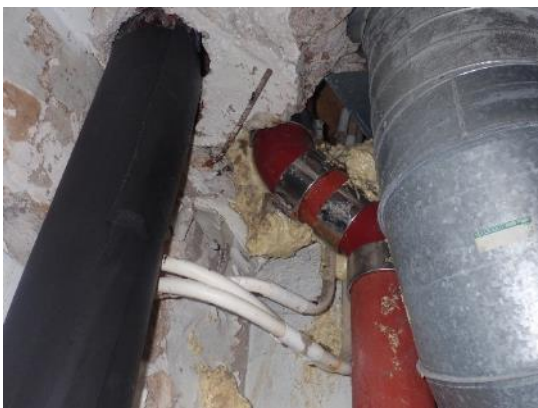
Kuva 112. Yläpohjan avoin läpivienti, varasto käytävän 111 vieressä
