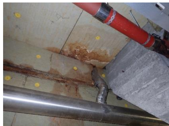
Kuva 8. Ison altaan liittymien ja läpivientien vuotokohdilla kosteusvaurioituneita eristevillalevyjä
