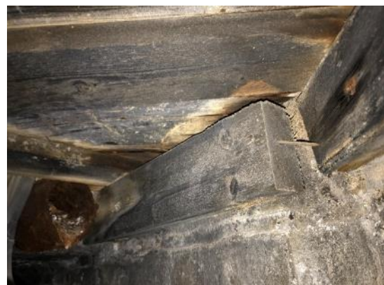
Kuva 67. Kosteusvaurioitunutta muottilautaa pesuhuoneen p06 alakattotilassa
