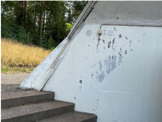
Kuva 30. Betonisen julkisivun kulunutta maalipinnoitetta ja rako betonikaaren ja räystäspellin liittymässä
