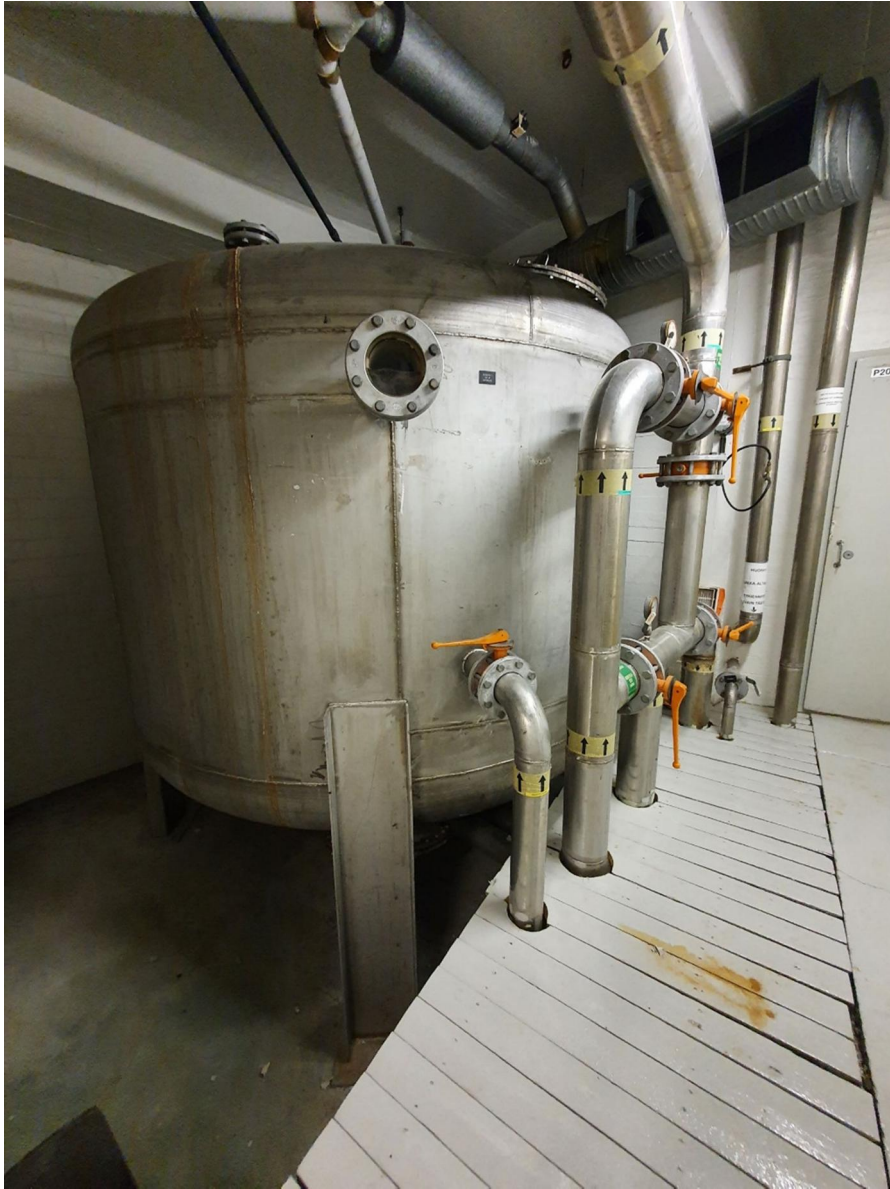
Kuva 3 Suodattimet on sijoitettu n. 1 metri kulkutason alapuolelle. Kulkutasolla ei ole kaidetta. Suodatinten tasolle kulkeminen on harvinaista. Kulkemisen apuna on askelmana käytettävä muovituoli.
