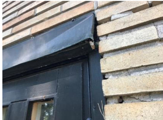
Kuva 47. Epätiivit vesipellin ja karmin liittymät ulkoseinään
