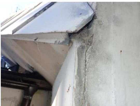
Kuva 106. Epätiisi kohta räystääpellin liittymässä
