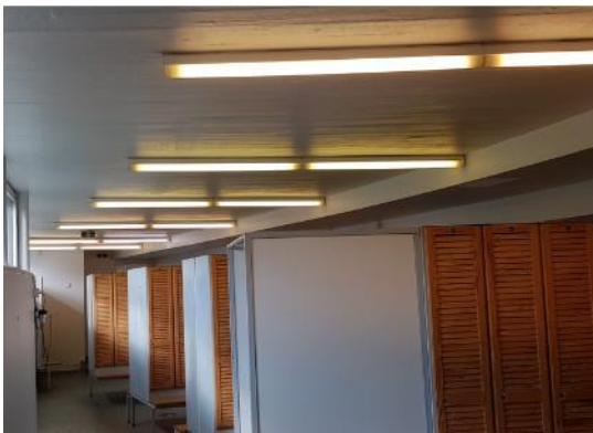
Kuva 141. Valaisimien kuvut ja putkenpitimet haurastuneita, miesten pukuhuone p04
