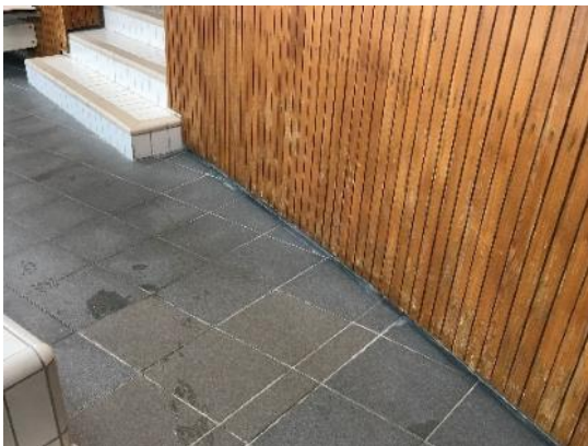
Kuva 86. Allashuoneen lakatussa puupaneeliseinässä kosteuden aiheuttamaa kulumista
