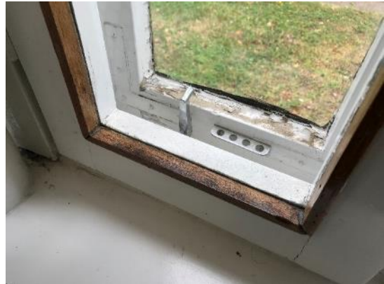
Kuva 45. Heikkokuntoinen alkuperäinen puu-ikkuna
