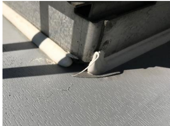
Kuva 111. Ilmanvaihtolaitteen sauman tiivistys ei jatku ulkokulmassa
