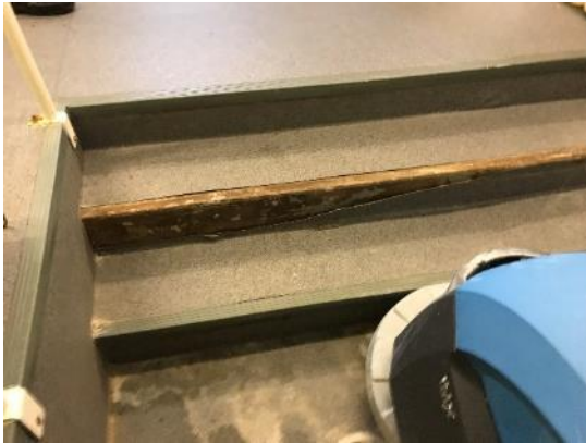
Kuva 68. Rikkinäinen muovimattopinnoite, varasto 122
