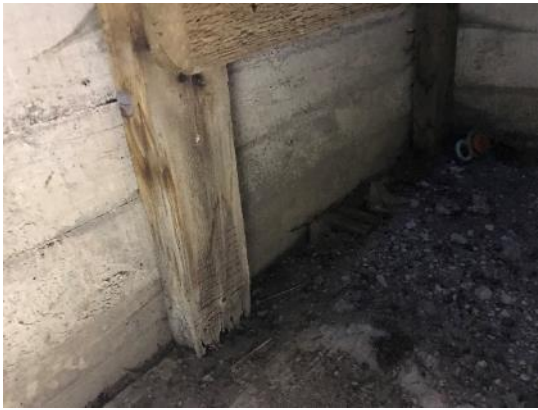
Kuva 17. Väestösuoja-tiloista lähtee yksi hätäpoistumistietunneli. Tunnelin puiset poistumistietikkaat ovat lahovaurioituneet.
