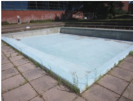
Kuva 52 Ulko-altaan pinnat ovat kuluneita
