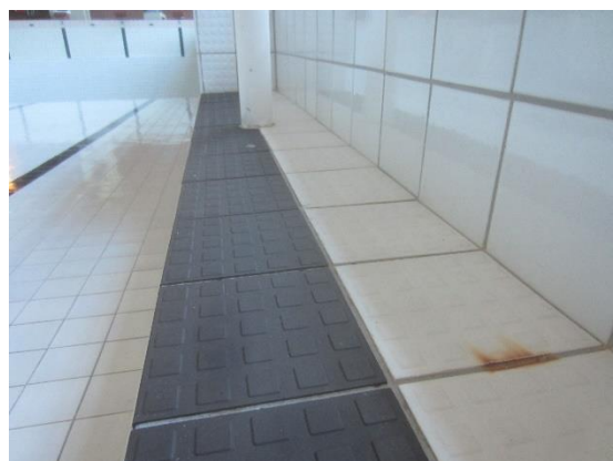
Kuva 16 Toinen ruoste jälki matalan päädyn portaassa.
