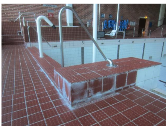
Kuva 42 Laatoitetuilla pinnoilla on nähtävissä paikallisesti pintojen kalkkeutumista.
