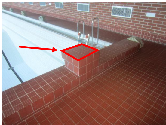
Kuva 35 Ison altaan 1. hyppypallin pinnassa on kopoa laatoitusta.
