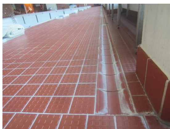
Kuva 43 Vesikourussa laattojen pintojen kalkkeutumista.
