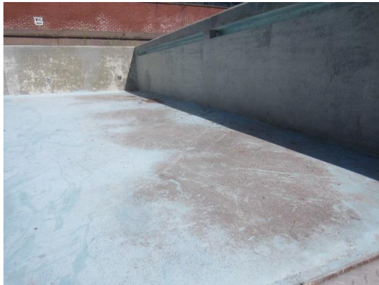
Kuva 54 Ulko-altaan pohjan pinnoitteet ovat kuluneet ja vaurioituneet.
