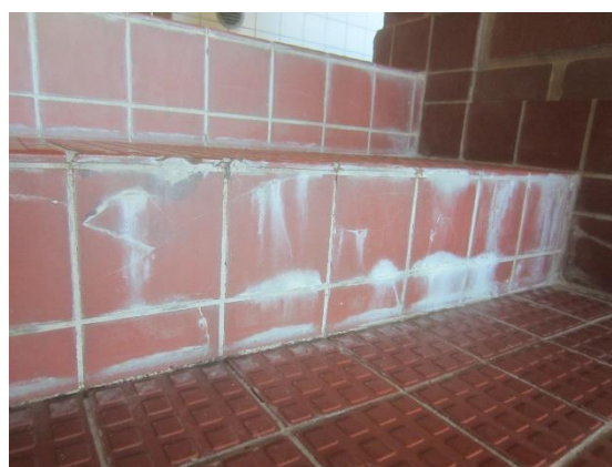
Kuva 41 Porraslaattojen halkeamista on nähtävissä kalkkivalumia.
