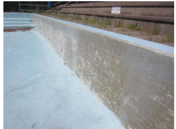
Kuva 53 Altaan seinäpinnoilla on nähtävissä verkkomaista halkeilua.
