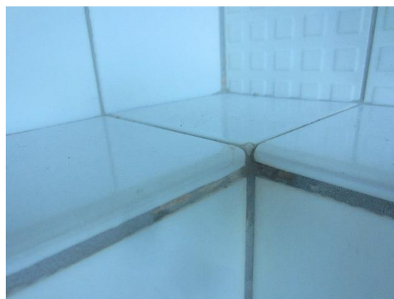
Kuva 18 Laattojen saumojen hyvin paikallista kulumaa.
