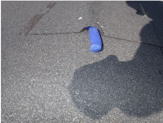
Kuva 80. Aukinainen sauma paikkauksen kohdalla
