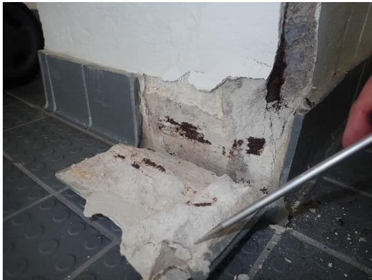
Kuva 49. Betonipilarin raudoitus on ruosteessa
