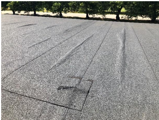
Kuva 62. Vesikatteessa vesihöyryn paineen aiheuttama venymä
