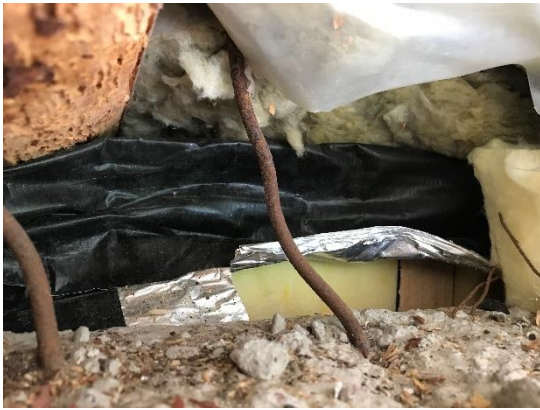
Kuva 27. Yläpohjan höyrynsulku ei liity tiiviisti seinärakenteeseen, avoin ulkoseinä- ja yläpohja rakenteeseen
