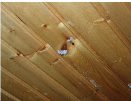
Kuva 58. Kondenssikosteusjälkiä paneelikaton näkyvällä pinnalla
