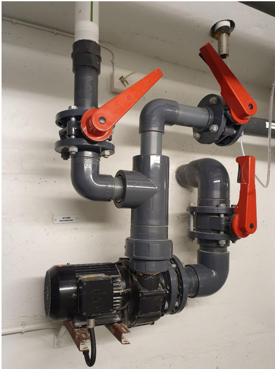
Kuva 7 Niskahierontapumppu ja putkijärjestelyt
