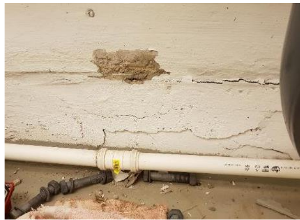
Kuva 18. Halkeama kellarin käytävän seinässä, uima-altaan ulkopuolella altaan pohjan kohdalla
