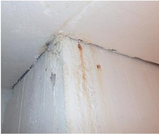
Kuva 15. Pilarin kohdalla on vuotojälkeä ja viitteitä raudoitteiden korroosiosta
