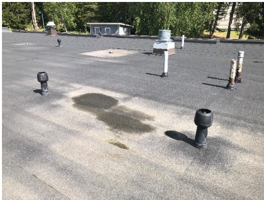
Kuva 70. Poikkeavan rakenteen osuus vesikatolla, lämmöneriste kermin alusrakenteena, painuma joka kerää vettä
