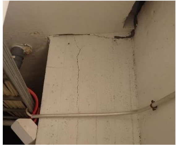
Kuva 16. Pilareissa on halkeamia
