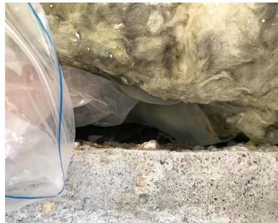
Kuva 26. Vanhaa höyrynsulkumuovia rakenteessa
