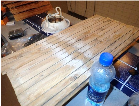
Kuva 60. Kondenssijälkiä paneelin taustapinnalla, mahdollisesti myös mikrobikasvustoa
