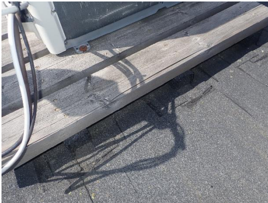
Kuva 83. Ikääntynyt ilmalämpöpumpun alusta ja kermi useasta kappaleesta
