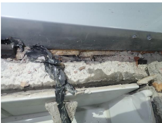
Kuva 34. Epämääräinen ikkunaliittymä, allashuoneen isot ikkunat, pellitys avattuna
