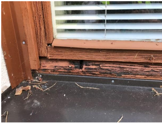
Kuva 36. . Vuonna 1988 uusittu ikkuna on huonokuntoinen
