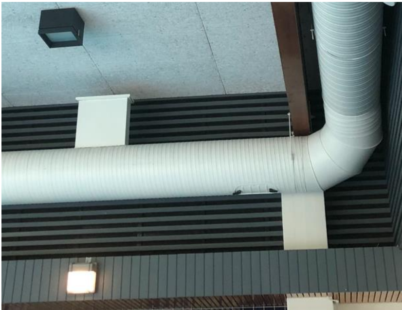
Kuva 98. Allastilan poistoilmakanava ja -säleikkö katon rajassa.
