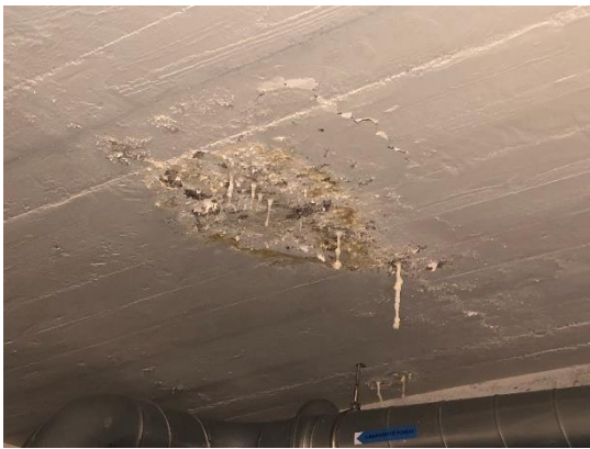
Kuva 47. Vuotojäljet lastenaltaan kohdalla
