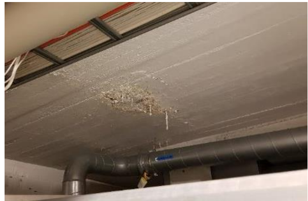
Kuva 29. Vuotokohta lastenaltaan pohjassa syvässä päädyssä
