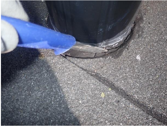
Kuva 81. Alipainetuuletusputken juuren liittymä on ikääntynyt, kitti murenee
