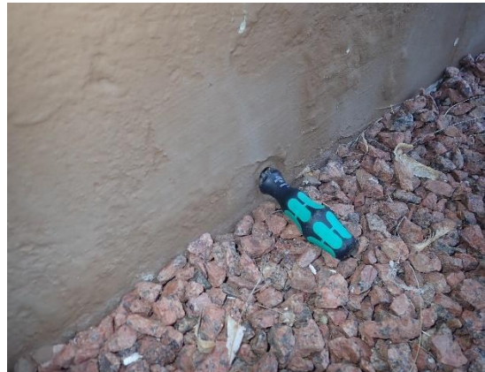
Kuva 20. Muottilukkoputken reikä perusmuurissa, sijain maanpinnan rajassa.
