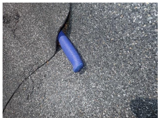
Kuva 77. Epätiivis sauma tuuletuskonsolin kohdalla
