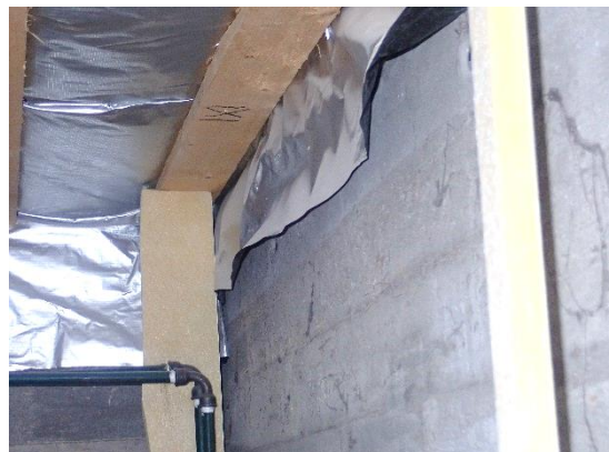
Kuva 55. Höyrynsulun liitos betonirakenteeseen, ei mitään tiivistystä/puristusliitosta
