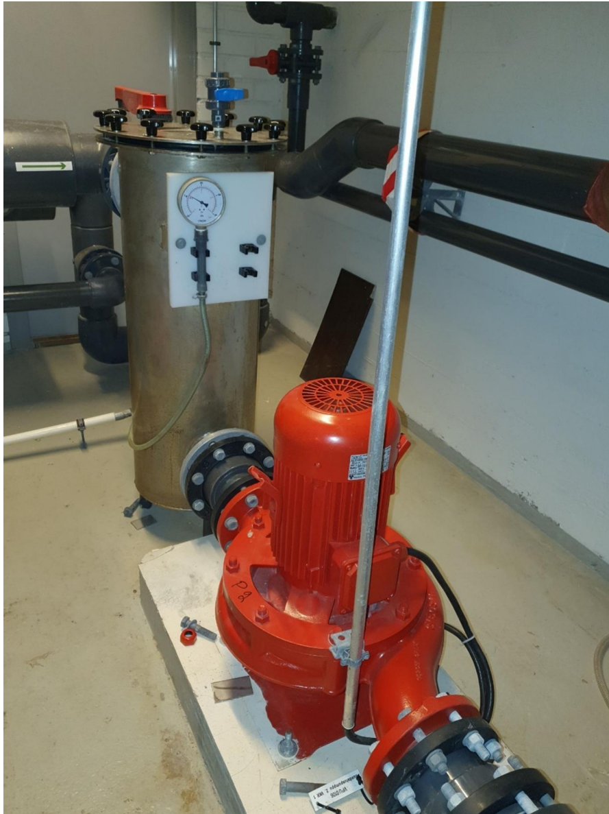
Kuva 1 Kiertovesipumppu ja karkeasuodatin.
