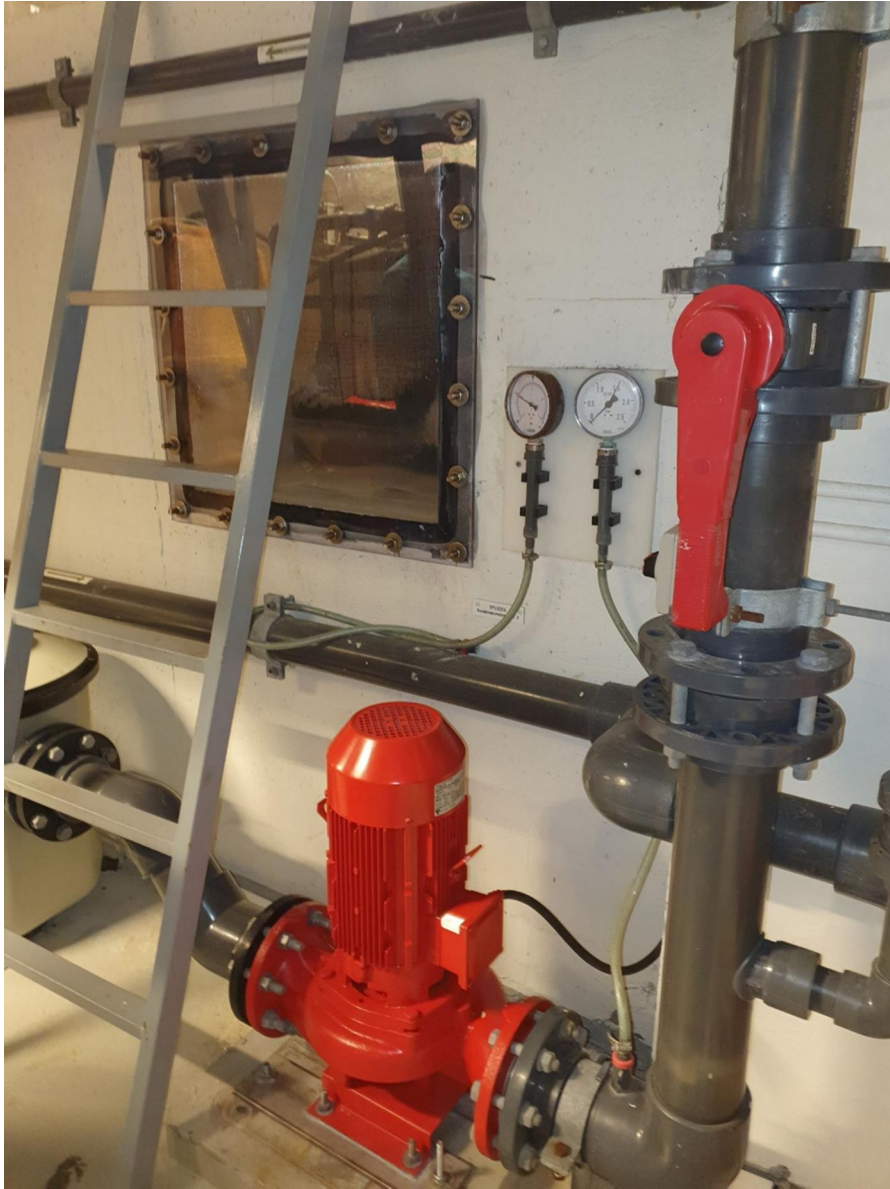
Kuva 5 Kulku porealtaan tekniikkatilaan ja tasausaltaan miesluukku.
