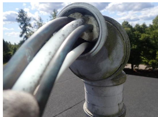
Kuva 84. Ilmalämpöpumpun läpivienti ei ole ulkoa tiivis, vesi- ja ilmavuoto sisätilojen suuntaan
