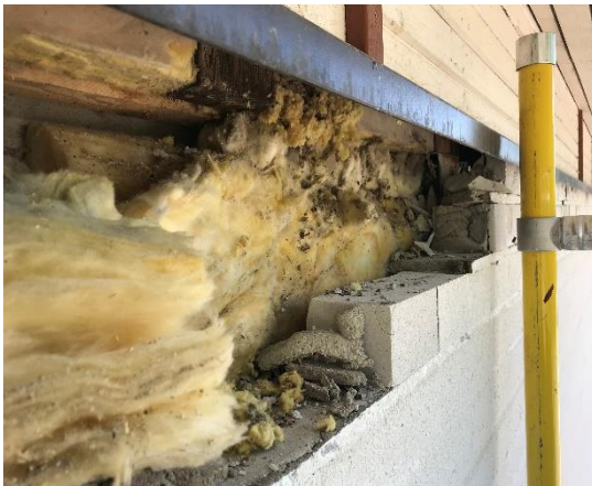
Kuva 25. Avatussa rakenteessa havaittavissa lahovaurioitunutta puuta
