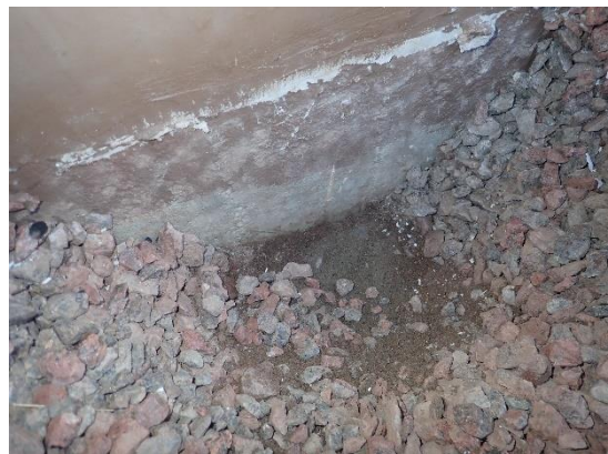
Kuva 18. Perusmuurin ulkopinnalta ei havaittu vedeneristystä
