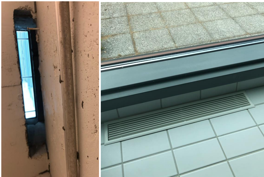
Kuva 97. Allastilan tuloilmasäleikkö alhaaltapäin iv-käytävästä kuvattuna ja allastilassa.
