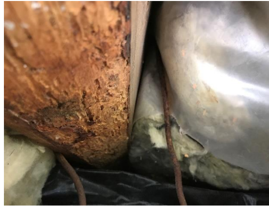
Kuva 28. Hyönteisvaurioita vanhojen vesikattorakenteissa
