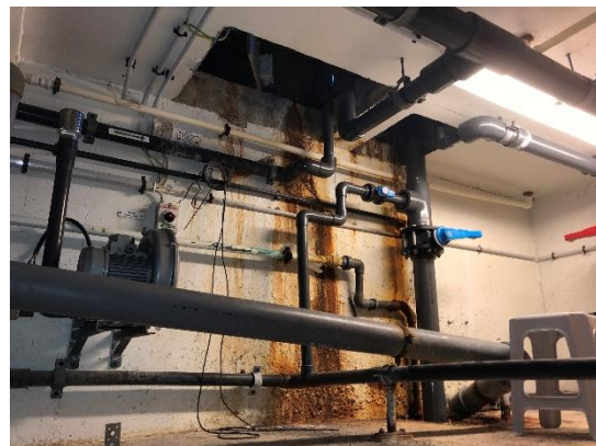
Kuva 46. Vuotojäljet porealtaan kohdalla
