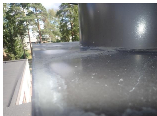
Kuva 86. IV laatikon päälle kerääntyy vettä ja nosto-/tiivistys putkeen puutteellinen
