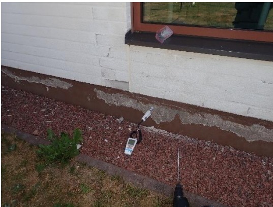
Kuva 17. Rapautunutta sokkeliä allastilan ulkoseinällä
