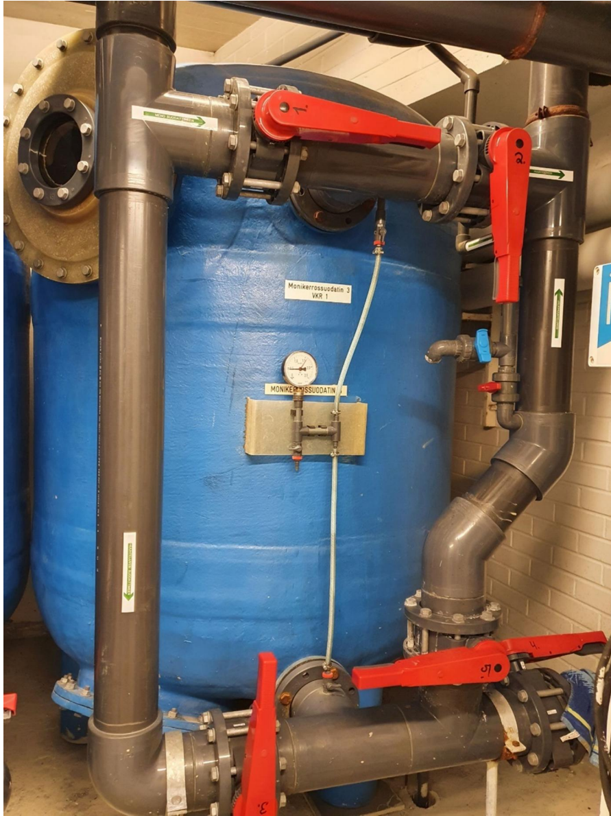
Kuva 2 Saneerauksen yhteydessä kunnostettu monikerrossuodatin ja etuputkisto vuodelta 1993.
