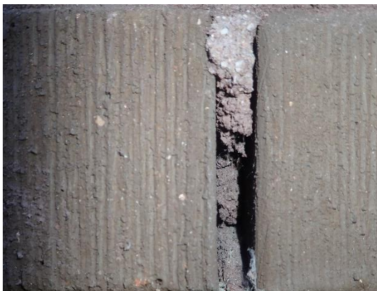
Kuva 31. Laastilla tukittu tuuletusaukko laajennusosalla
