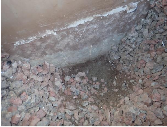
Kuva 90. Sokkelin vierustan erotuskaista, ei patolevyä/vedeneristystä
