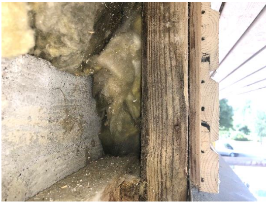
Kuva 29. Kosteusvaurioitunutta ulkoseinän puurakennetta
