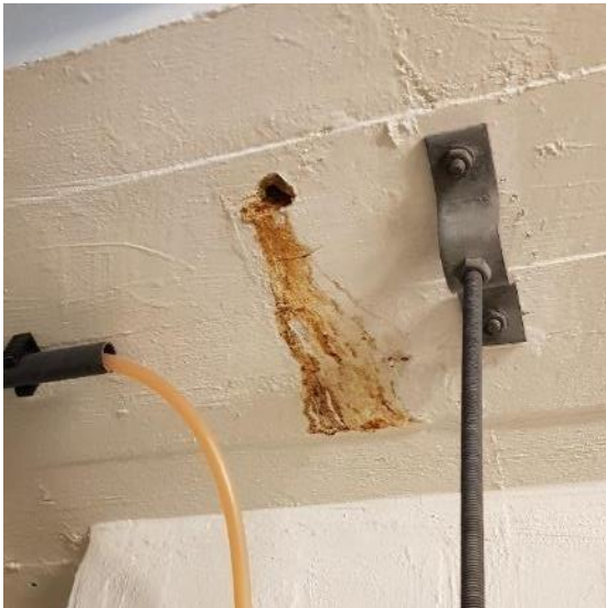
Kuva 13. Vuotojälki kellarin käytävän katossa
