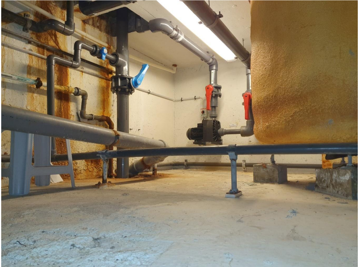
Kuva 4 Porealtaan tekniikka on sijoitettu matalaan tilaan n. 1,5 m korkeudelle lattiasta. Tasolla ei ole kaidetta.
