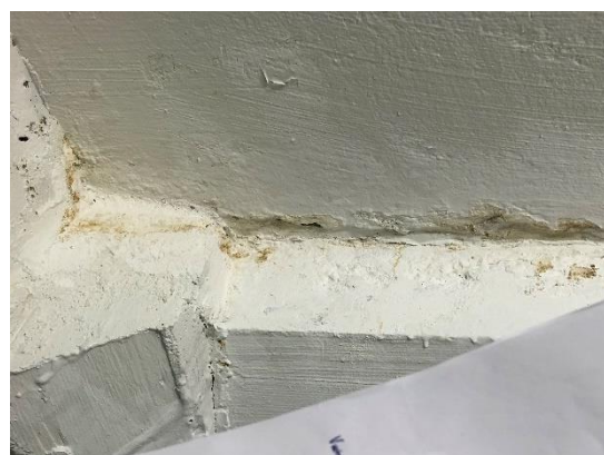
Kuva 48. Vuotojälkiä uima-altaan kohdalla
