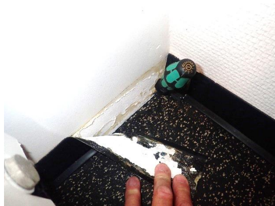
Kuva 8. Laajennusosan alapohjaliittymä ei ole tiivis, ilmavuoto sisätilojen suuntaan.
