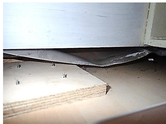
Kuva 69. Kuntosalin laajennusosan höyrynsulun liittymä on avoin, ei teippausta liittyviin rakenteisiin.
