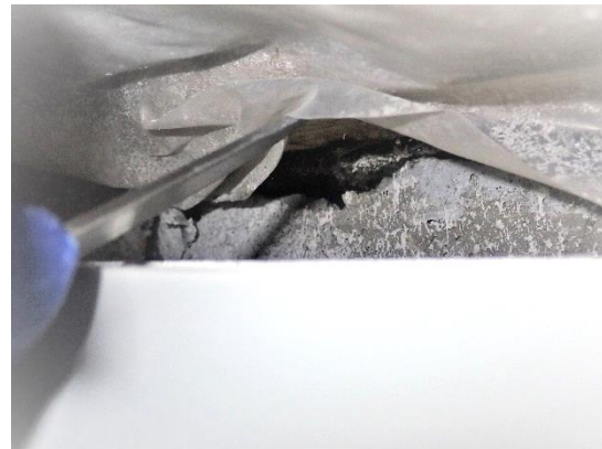
Kuva 67. Kuntosalin pääty, itäpääty, höyrynsulun liittymä ulkoseinään on avoin.
