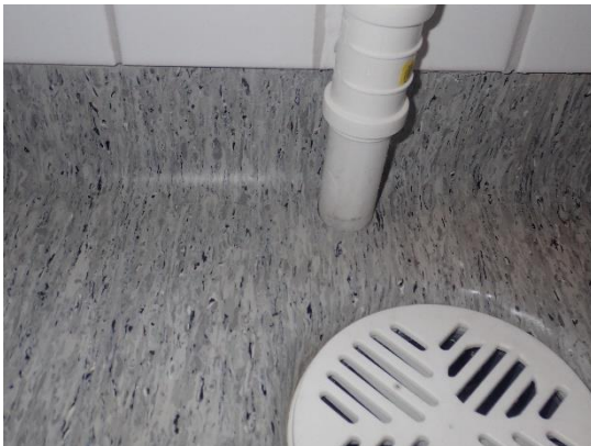
Kuva 9. InvaWC:n altaan poistoputken liittymä muovimattoon on avoin
