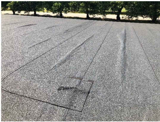
Kuva 78. ullistunut kermi vesikattokannattajan kohdalla
