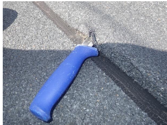
Kuva 79. Kermin sauma kannattajan kohdalle, jolloin kermin sauma repeytynyt irti
