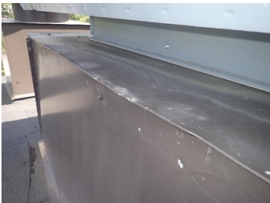
Kuva 85. IV laatikon kannen päälle kerääntyy vettä, tiivistys-/nosto kanavaa vasten puutteellinen
