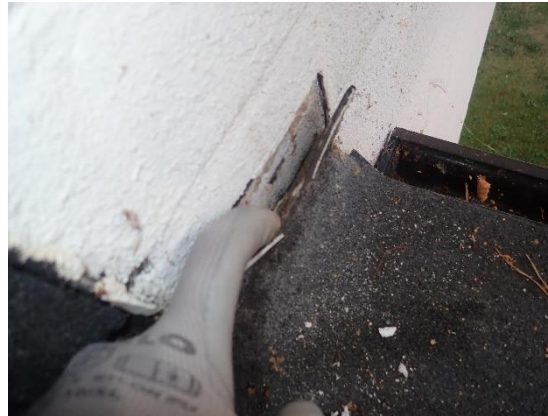
Kuva 75. Matala nosto räystäään läheisyydessä on suojaamatta pellillä ja kermi irti tiilipinnasta
