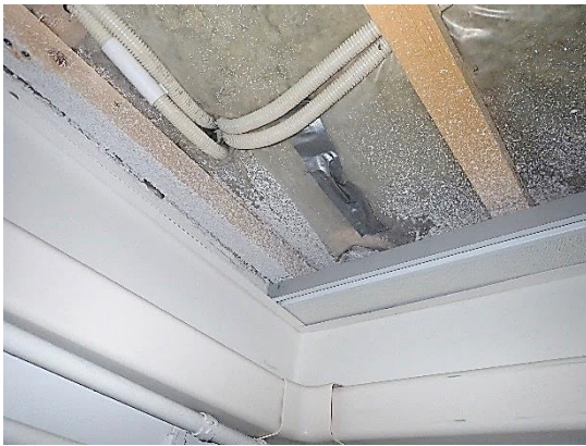
Kuva 66. Kuntosalin yläpohjan höyrynsulun liittymä pohjoissivu ulkoseinärakenteeseen, sähköputki reikä tiivistämättä
