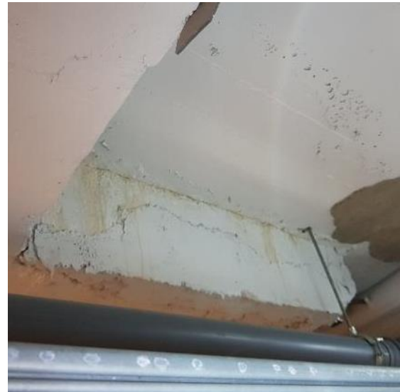
Kuva 14. Vuotojälkiä kellarin käytävän katossa
