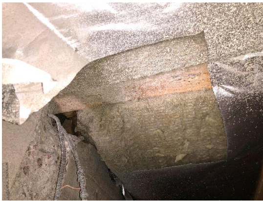
Kuva 52. Puuttuva alue (aulan invaWC) höyrynsulusta sekä ilmayhteys yläpohja- ja ulkoseinärakenteisiin
