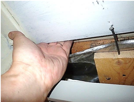
Kuva 68. Kuntosalin yläpohjan höyrynsulun liittymä laajennusosan rajalla, liittymä avoin
