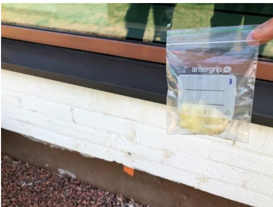
Kuva 19. Vesipellin alta ja tiilisauman kautta kosteuden siirtymä jälkiä.
