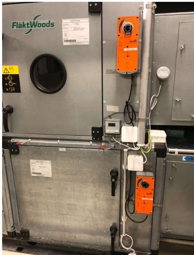
Kuva 95. Ilmanvaihtokone TK02, Fläkt Woods Oy
