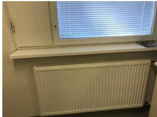
Kuva 39. Henkilökunnan tilojen ikkuna sisätilojen puolelta, ilmavuotoa ikkunapenkin alta
