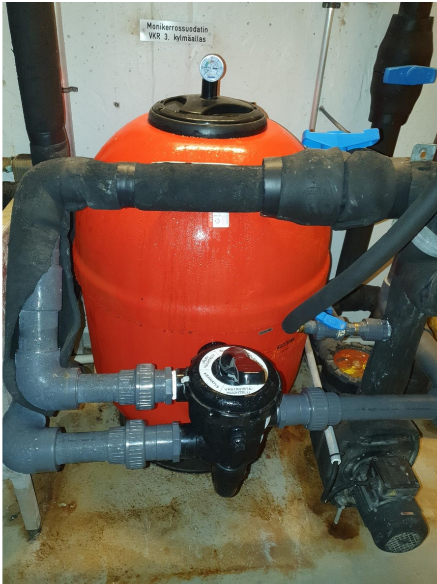
Kuva 3 Kylmäaltaan pikasuodatin on uusittu vuonna 2020.
