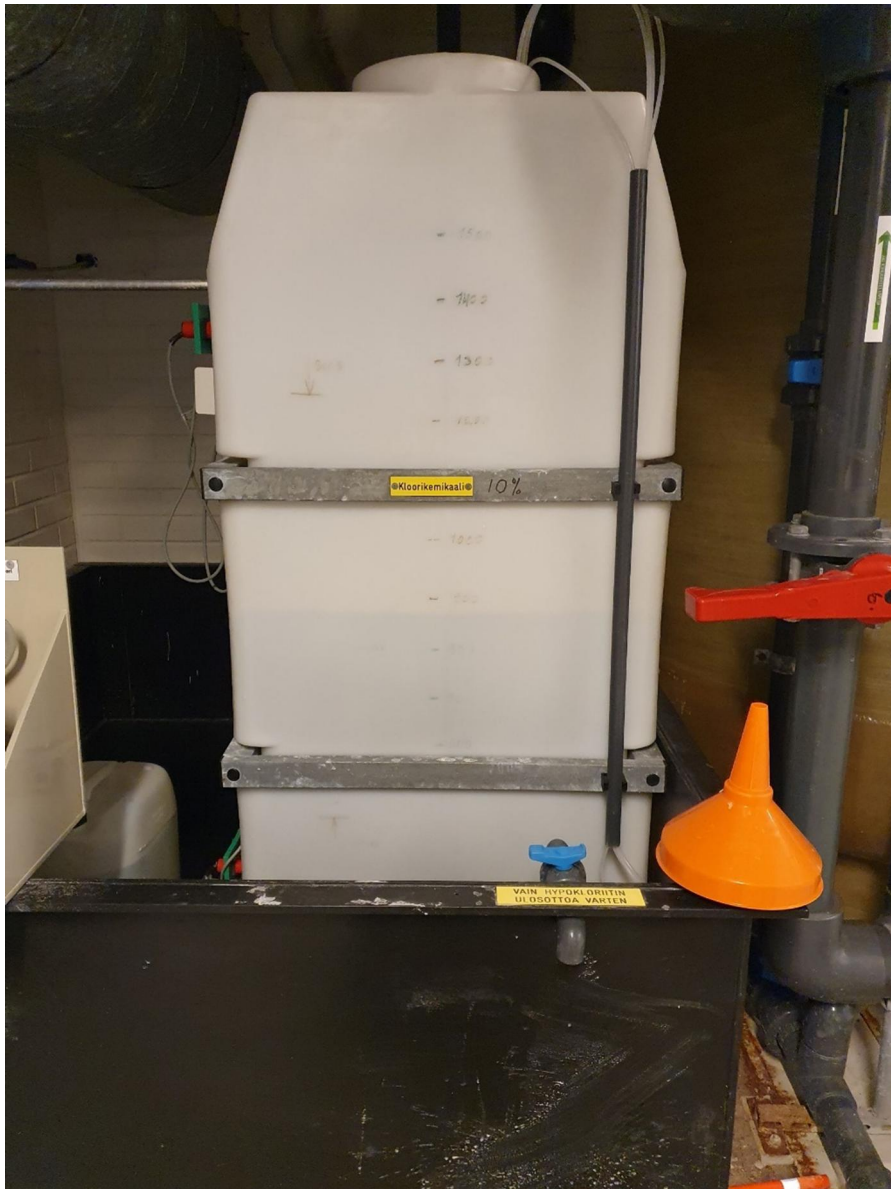
Kuva 6 Kloorisäiliö on sijoitettu tekniikkakäytävään.
