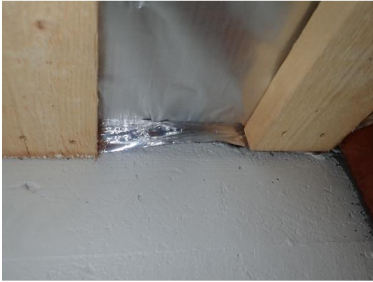
Kuva 54. Höyrynsulun liitos seinärakenteeseen aluteipillä, teippi irti betonirakenteesta
