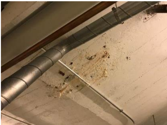
Kuva 28. Vuotokohta lastenaltaan pohjassa, altaan portaiden alaosan alla
