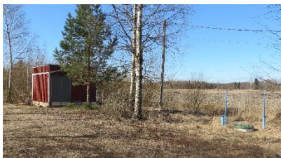
Kuva 39. Peltoalueen keskellä sijaitsee jätevesiviemäriverkoston pumppaamokennus.
